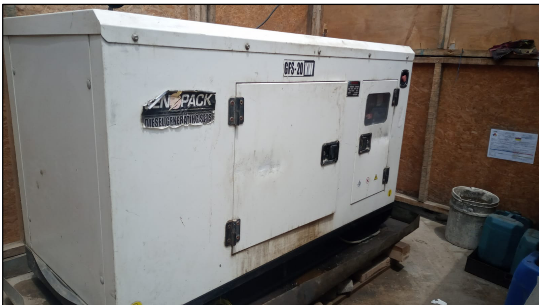
Generador eléctrico sobre bandeja antiderrames
