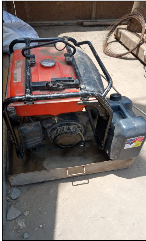
Grupo electrógeno sobre bandeja antiderrames
