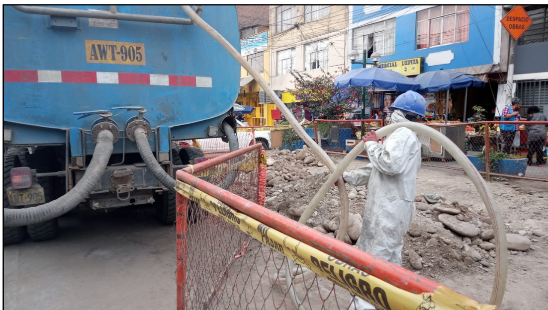
Cisterna de agua para mitigación de polvos
