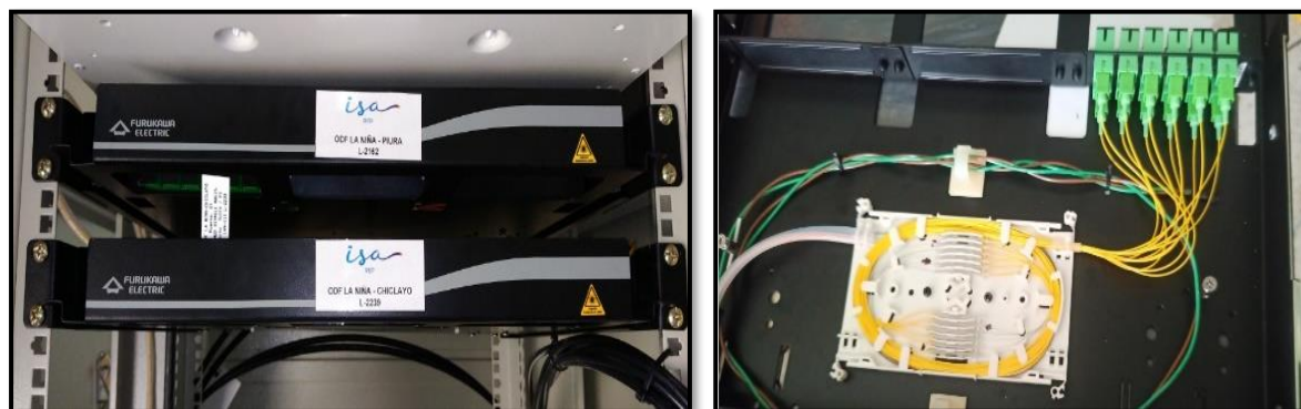
Figura N°20: ODF en las subestaciones eléctricas
