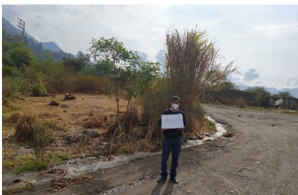
Fotografía 04 Vista del área afectada donde se construía la vía Evitamiento Abancay.
