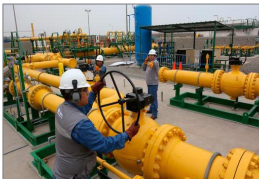
Instalaciones de City Gate Lurín
