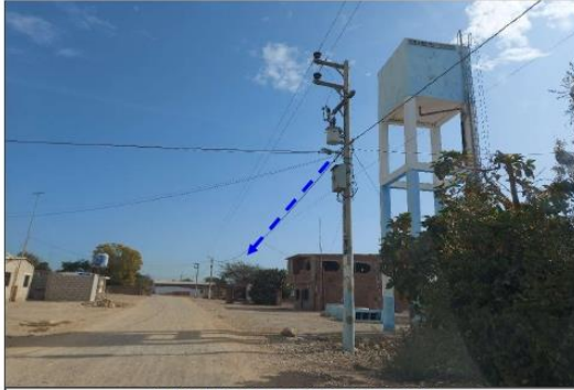
TRANSFORMADOR MAS CERCANO
