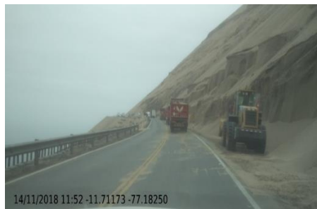
Carretera PE-1NA arenamientos en la vía
