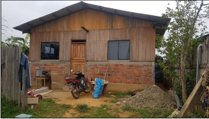
Figura 1N: Infraestructura de una vivienda en la ciudad de Iñapari, se observa que esta construido por material de ladrillo y madera, esto debido a que la inundación llega hasta esa altura. (E= 436,949.03 m, Y= 8,789,898.52 m) Fecha de captura: 17/06/2021
