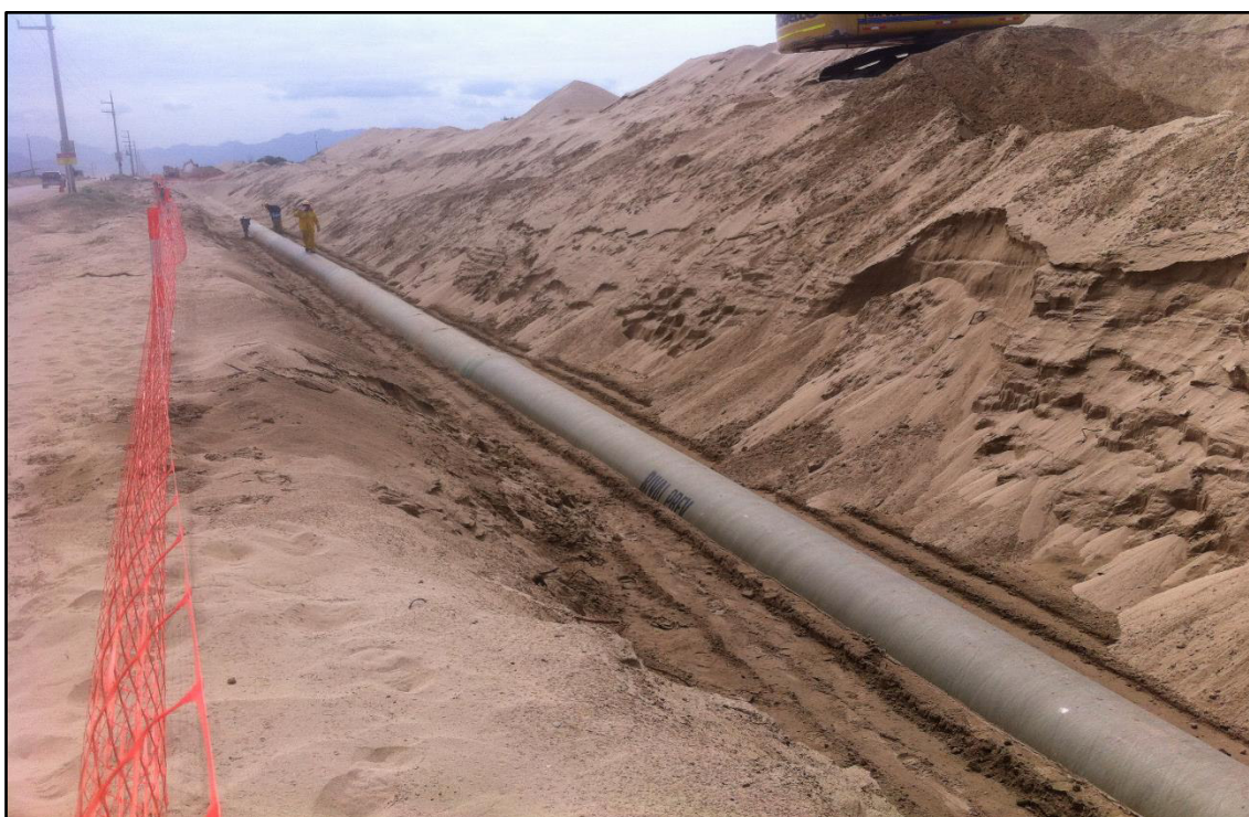
Fotografía 10. Instalación de tuberías GRP DN 800mm de la Línea de Conducción de Agua Tratada.
