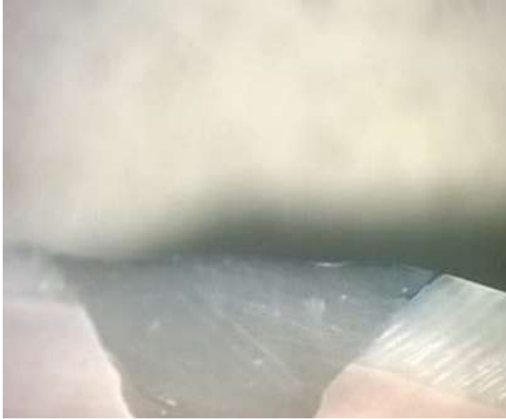
FOTOGRAFIA N°1 Grado de Microfiltración 1
