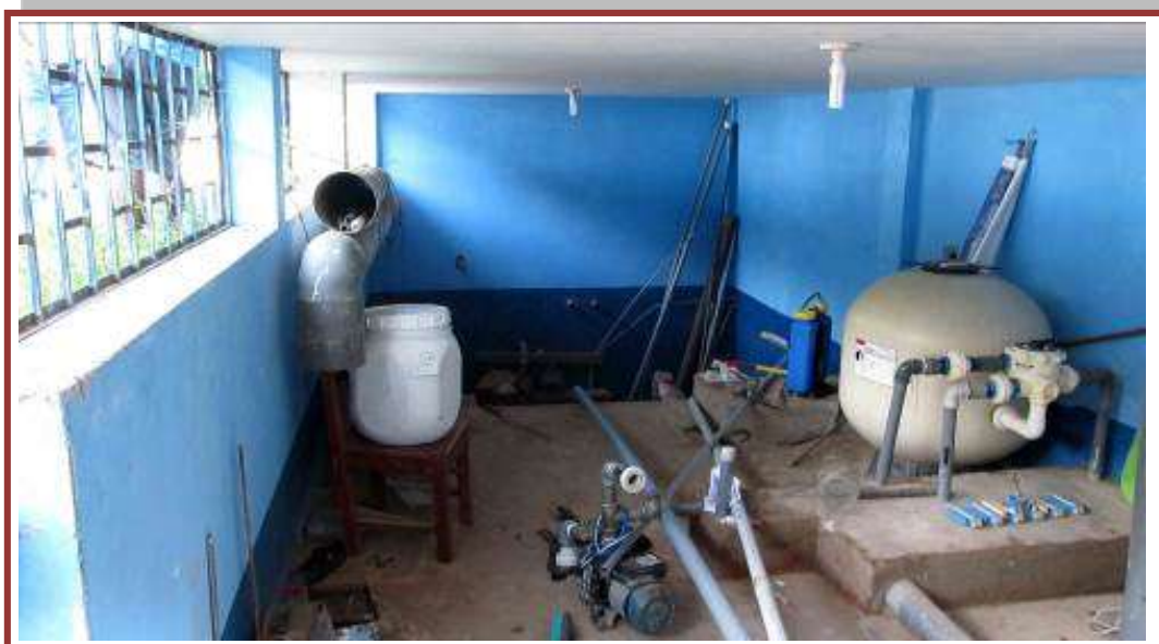
Vista Interna del Cuarto de Maquinas
