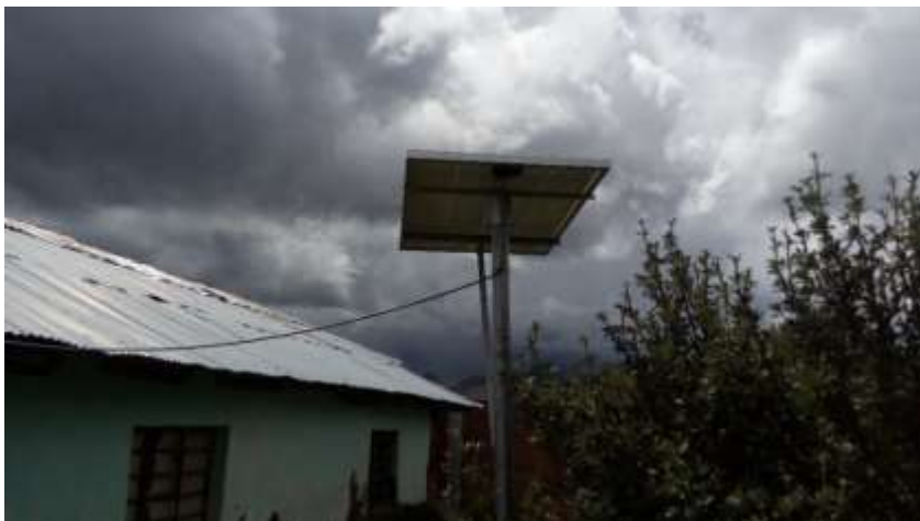
Figura 51 Panel solar en Mayupampa. Fuente: Elaboración propia.
