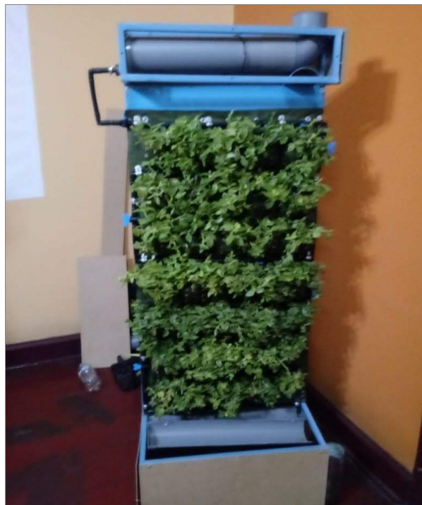
Figura 38. Implementación final del sistema de riego del jardín vertical piloto. Fuente: Elaboración propia.
