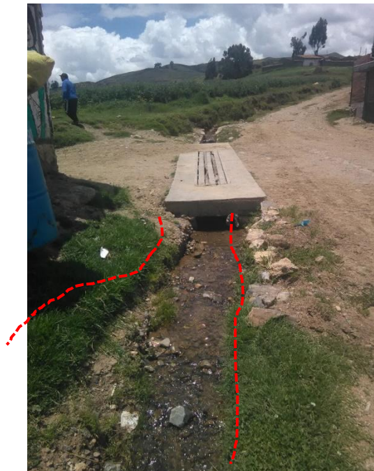
El “puente” con rejilla sobre una acequia permite la circulación vehicular sin mayores problemas, , pero la acequia sin revestimiento del canal de aguas abajo, va profundizando el cauce, convirtiéndose con el tiempo en cárcavas. Huaripampa.
