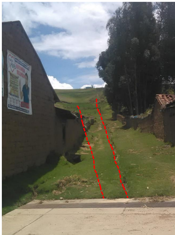
Calle deteriorada, acequia que ira profundizando hasta formar cárcavas si no hay control. Huaripampa.
