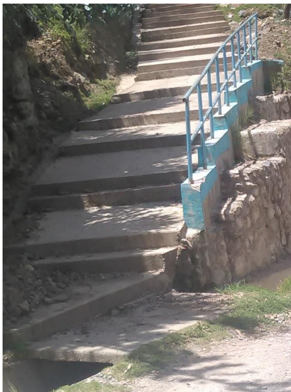
Escalinatas en camino de fuerte pendiente, evita la erosión y derrumbes – Villa Olleros.
