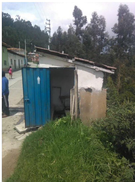
SS.HH. sobre la acequia que cruza a la avenida principal de la Villa y desemboca al río negro después de una caída de 20 a 30 mt de altura. Lo preocupante, no hay protección que evite el desmoronamiento del cauce que en el futuro se convertirá en cárcava y quebrada. Villa Olleros
