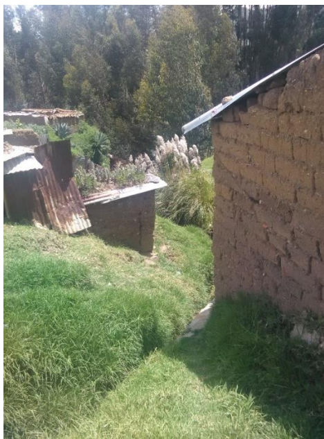
Cabecera Q. Uchush Utcu- Cauce principal resultado de erosión remontante, casa vulnerable. Huaripampa.
