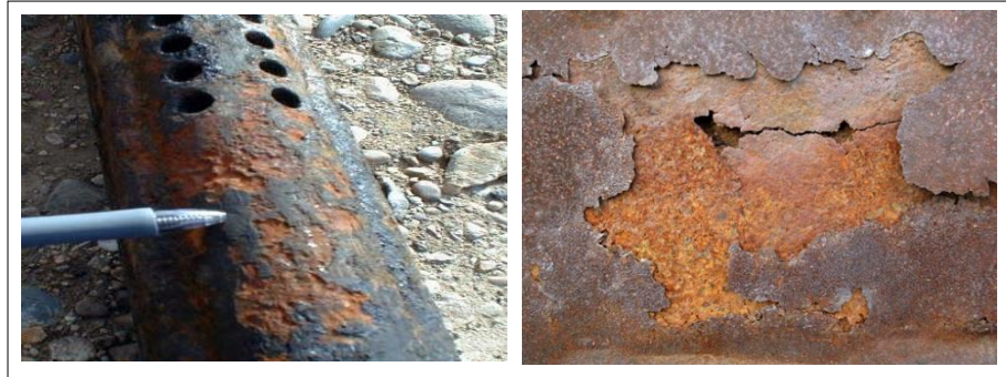
Figura 13. Corrosión externa de ductos
