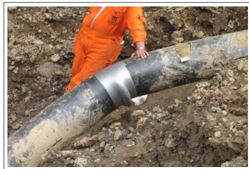
Figura 14. Corrosión bajo esfuerzo o por estrés
