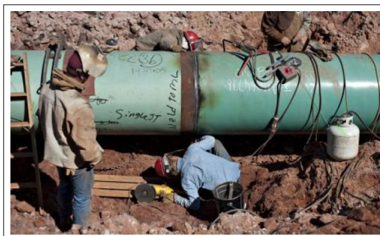
Figura 16. Rotura de ducto de gas natural
