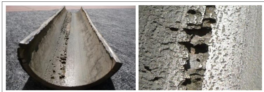
Figura 12. Corrosión interna de ductos
