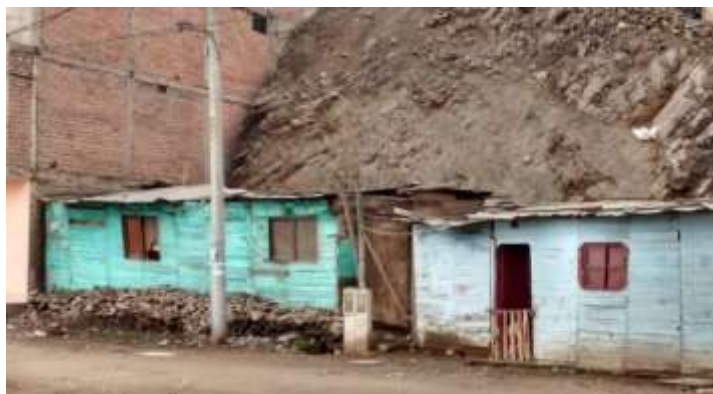
Figura 27. Viviendas que presenta un muy mal estado de Conservación. Mz J Lt 8 y 9 – AA.HH La Flor Etapa 2, Sector 2 – Carabayllo. Fuente: Elaboración Propia
