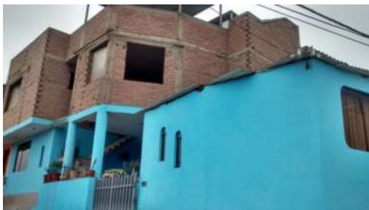
Figura 37. Vivienda que presenta 3 Pisos. Mz B Lt 11 – AA.HH La Flor Etapa 2, Sector II – Carabayllo. Fuente: Elaboración Propia
