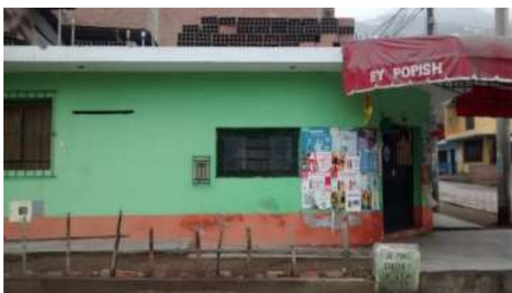
Figura 41. Vivienda que presenta Materiales de Construcción como Cargas vivas en el techo. Mz 82 Lt 04 – AA.HH La Flor Etapa 1 – Carabaylo. Fuente: Elaboración Propia
