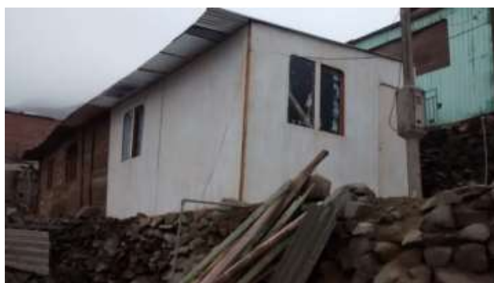
Figura 23. Vivienda que presenta Madera como material predominante en las paredes. Mz E Lt 16 – AA.HH La Flor Etapa 2, Sector 1 – Carabayllo. Fuente: Elaboración Propia
