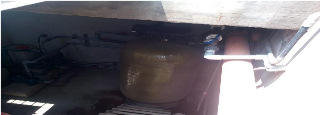
Figura N°A. 4: FILTRO MULTIMEDIA PCTAR COMAS
