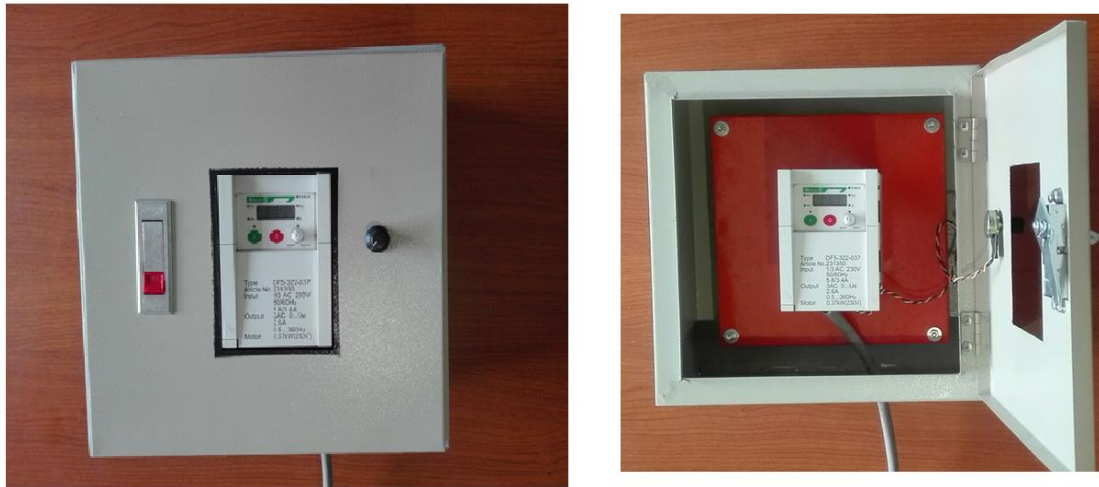
Figura 54. Variador de Frecuencia marca MOLLER.
