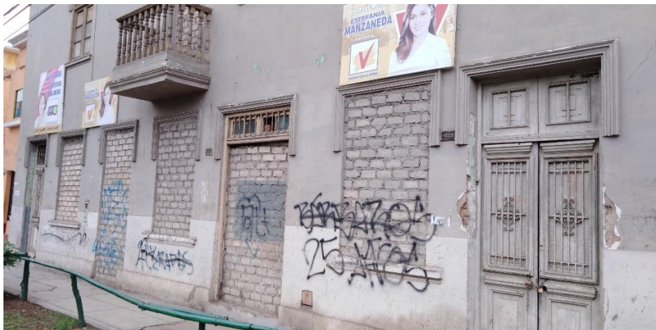
Vivienda tapiada con riesgo de derrumbe interno.
