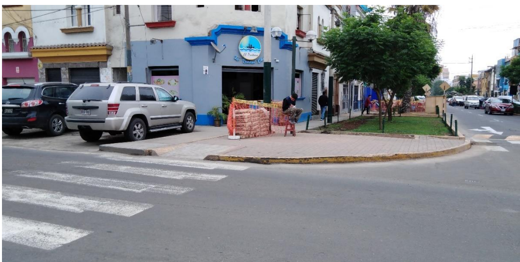
Materiales de construcción ocupando espacio en veredas interrumpiendo acceso a rampa.
