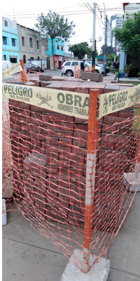
Materiales de construcción ocupando veredas.
