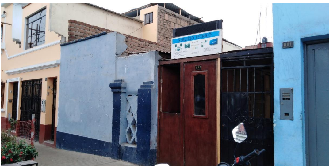
Pared de adobe en malas condiciones.
