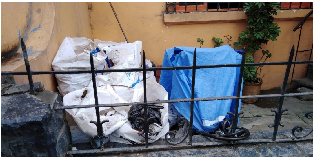
Residuos de construcción y demolición en el patio exterior de una vivienda.
