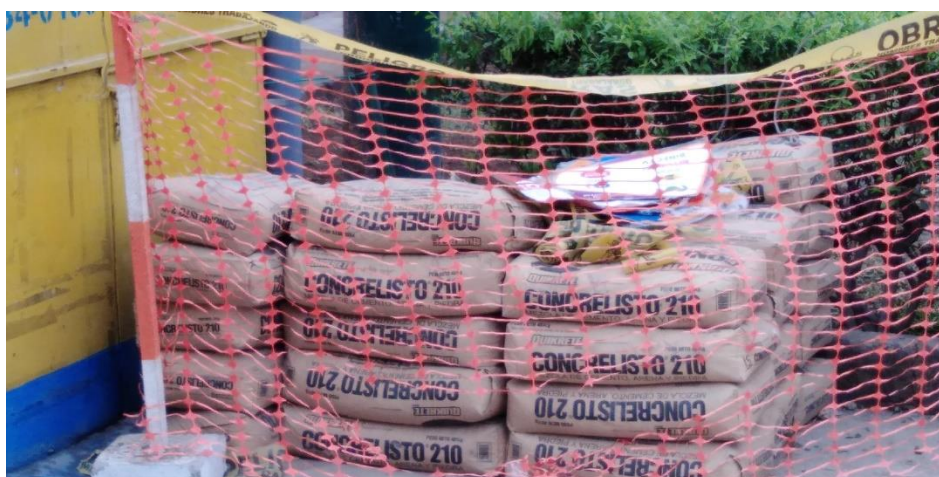
Materiales de construcción enmallado ubicado en veredas en el distrito de Jesús María.
