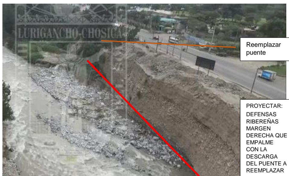
Figura 39. Erosión en la margen derecha del río Rímac
