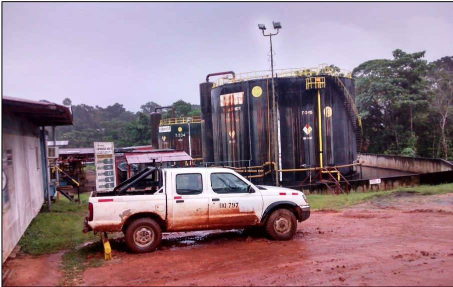
Figura 6 Baterías, instalaciones de procesamiento, estaciones de bombeo
