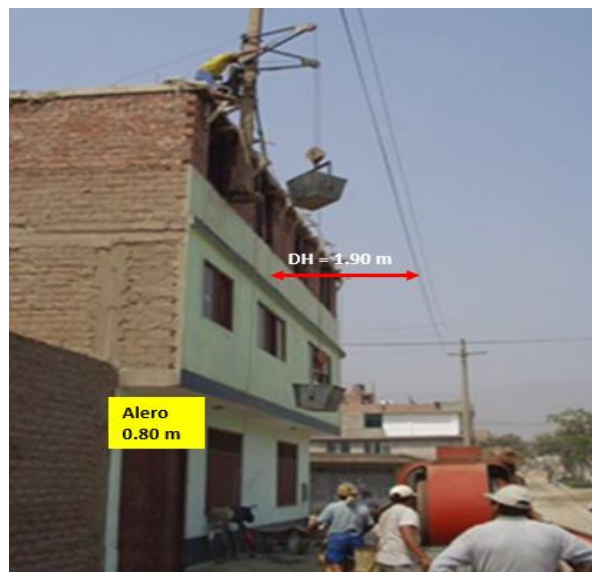
Figura 5. Invasión a la distancia de seguridad horizontal en la instalación de distribución eléctrica
