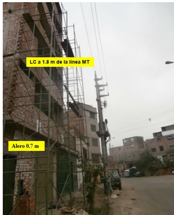
Figura 3. Invasión a la distancia de seguridad horizontal en la instalación de distribución eléctrica
