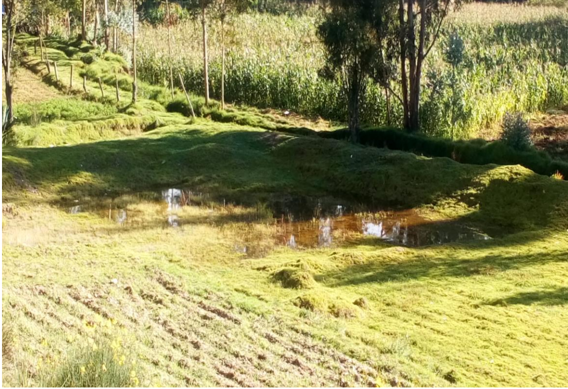
FOTO N° 11 PRESENCIA DE HUMEDAD EN LA PARTE BAJA DE VÍA, ( LADO ESTE.)
