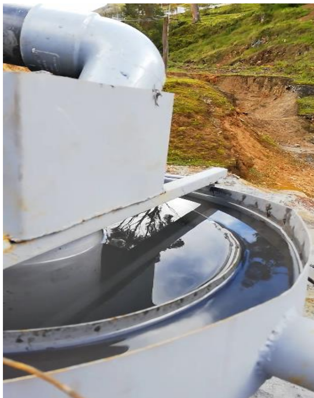
Foto 16: Rebose de agua clarificada
