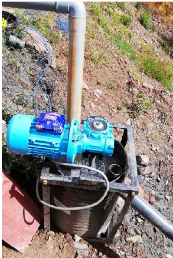
Foto 14: Acondicionador de pulpa
