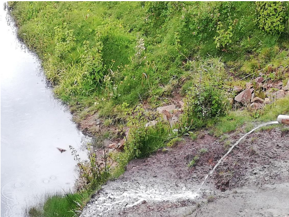
Foto 18: Descarga de agua clarificada
