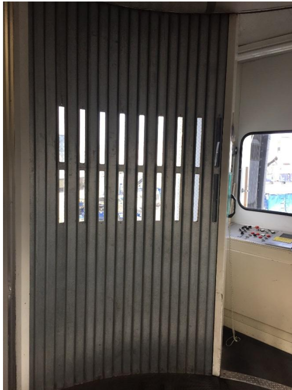
Gráfico 14. Cortinas metálicas de la cabina
