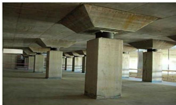
Figura 2.43: Aisladores elastoméricos instalados en el Hospital del Mares, Italia
