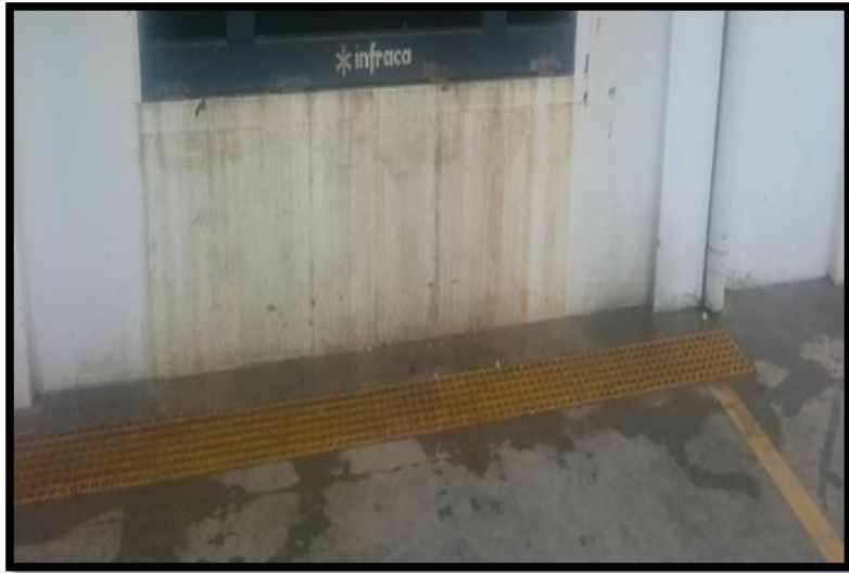
Figura N° 43: Vista de Cámara 3
