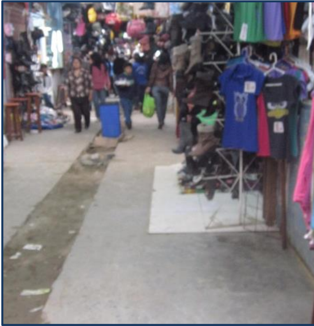
Imagen 33: Pasajes, Muestra El Deterioro De Pasillo Y Alcantarillado Fuente: Fotografía Propia
