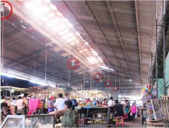
Figura 50. Iluminación deficiente en el edificio principal. Fuente: Elaboración propia
