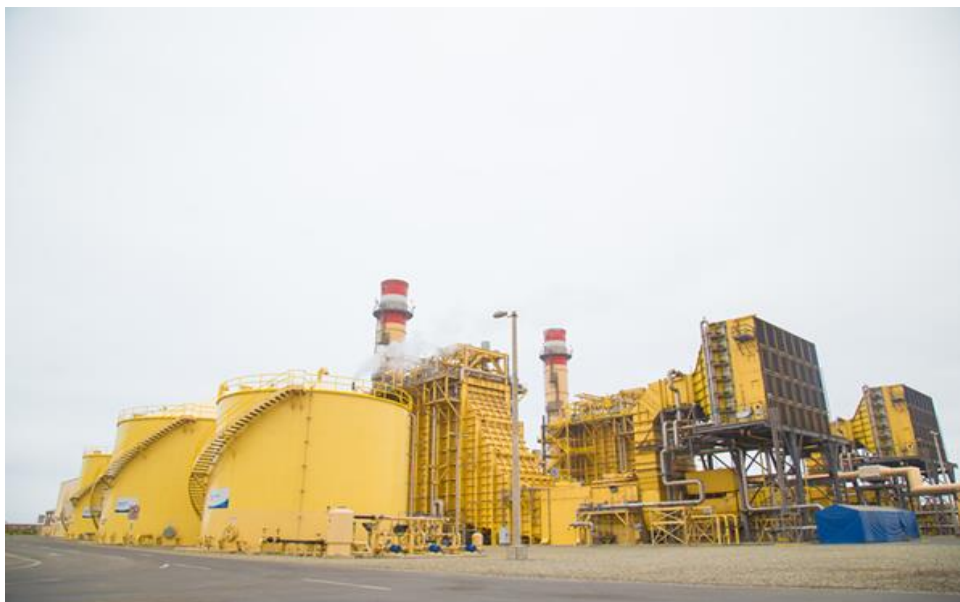
Figura 3.8: Central térmica Fénix Power. Fuente: (Fénix, 2018)
