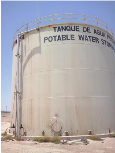
Figura 20: Tanque de almacenamiento de Agua Potable (existente) Fuente: CPI Warley Parsons Basic Engineering
