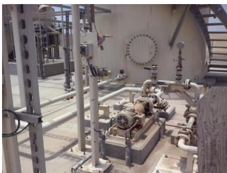
Figura 19: Vista de tanque de efluente tratado (existente) Fuente: CPI Warley Parsons Basic Engineering
