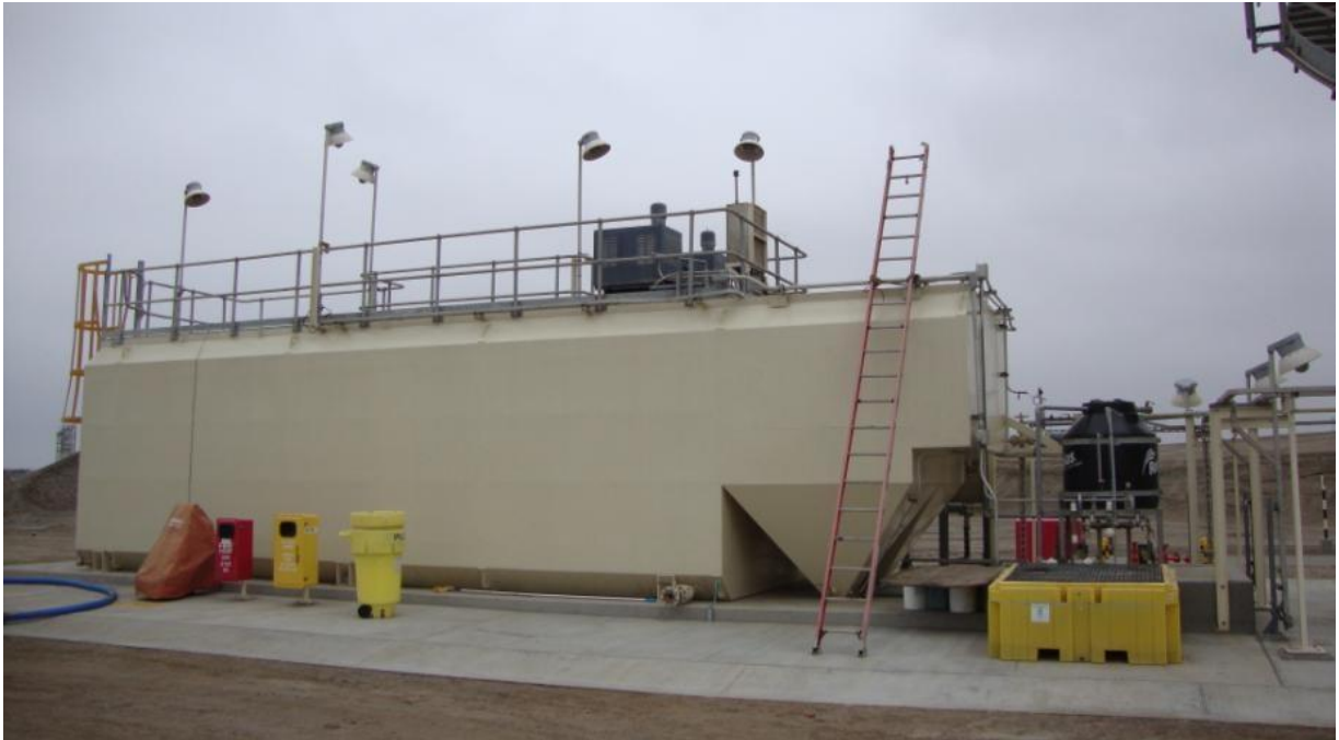
Figura 8: Planta de Tratamiento de Aguas Residuales Domésticas (PTARD) de PERU Lng Fuente: Peru LNG Memoria Descriptiva
