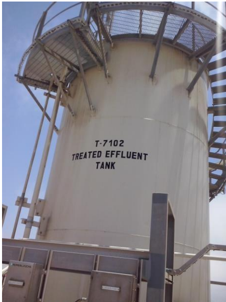
Figura 18: Tanque de efluente tratado (existente) Fuente: CPI Warley Parsons Basic Engineering
