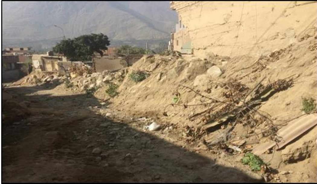
Fotografía N° 3: Muros de contención destruida y zona de inundación
