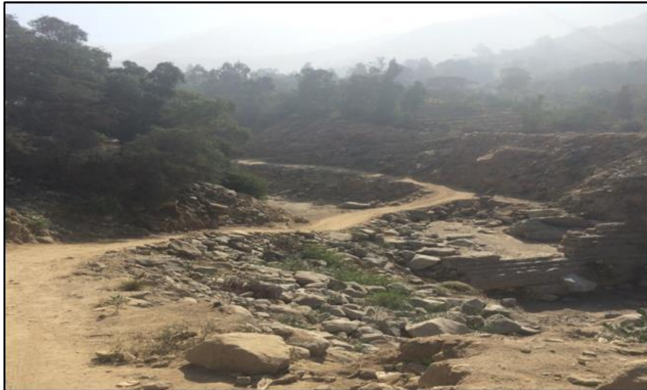
Fotografía N° 15: Dique destruido por la fuerza de caudal y el arrastre de rocas
