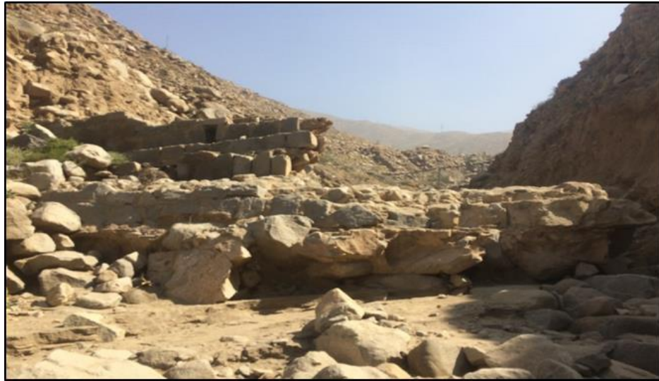
Fotografía N° 16: Otro dique destruido de la misma manera
