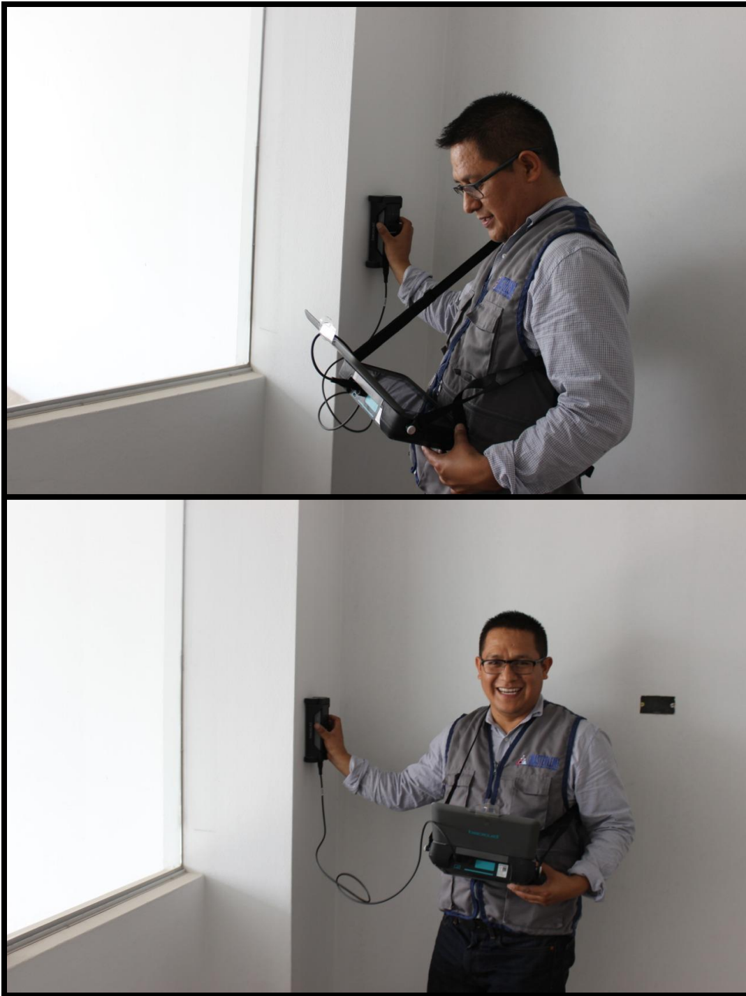
Figura 58: Ensayo de detección de barras de refuerzo del concreto de la estructura completamente acabada
