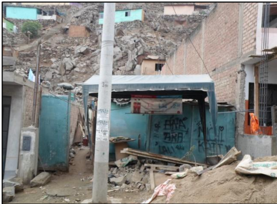
Fotografía 6. Mz C Lt 08 – Vivienda altamente vulnerable
