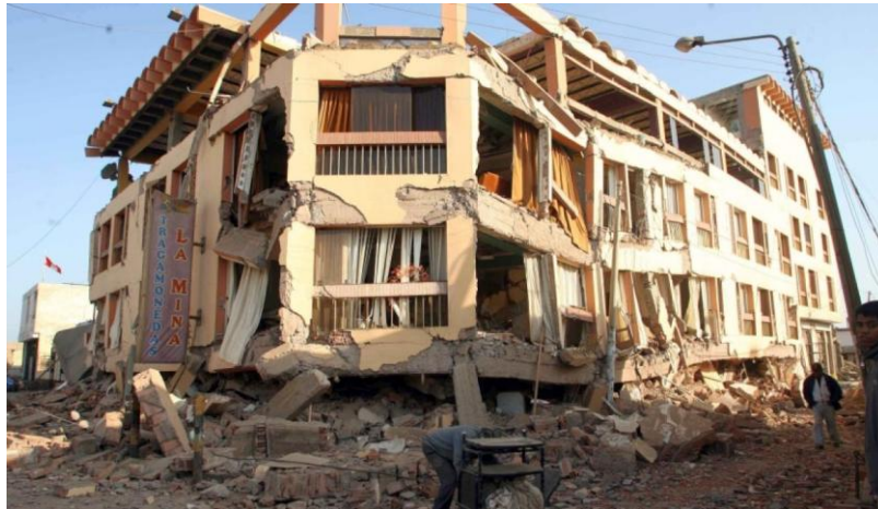
Imagen 10: El Hotel Embassy quedó destruido tras el terremoto de Pisco 2007.
