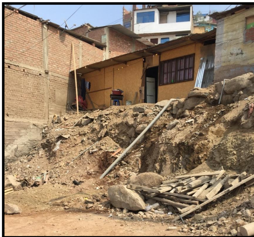
Fotografía N° 11. Vivienda sobre área erosionada en el Jr. El Corregidor en el sector 38 del P.J Virgen de Lourdes - V.M.T. - 17/02/2018 (Fuente: Propia)
