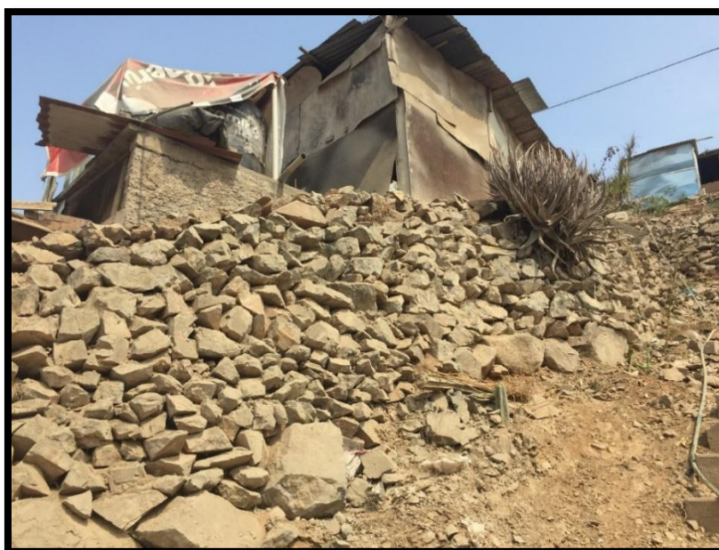
Fotografía N° 12. Viviendas sobre pircas de piedra en el C.V. 11- 12 Sur - V.M.T. - 17/02/2018 (Fuente: Propia)
