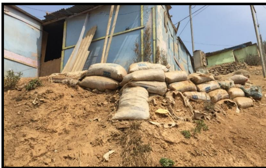
Fotografía N° 15. Vivienda improvisada de triplay con base de costales terreros en el C.V. 11- 12 Sur - V.M.T. - 17/02/2018 (Fuente: Propia)
