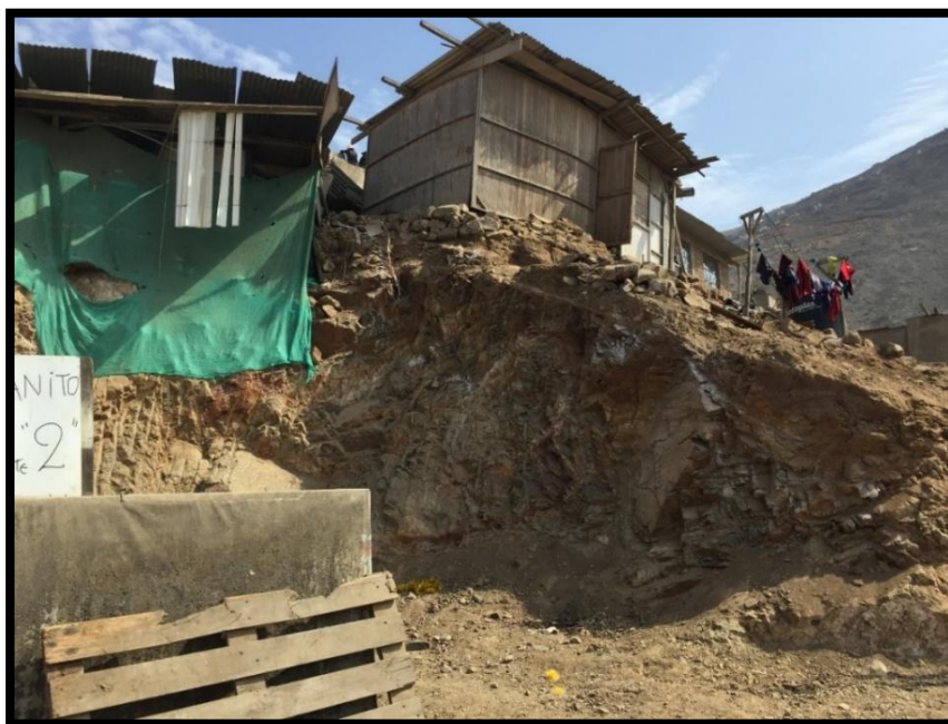
Fotografía N° 17. Vivienda improvisada de madera sobre suelo inestable por acción antrópica en la Asociación San Juanito - V.M.T. - 06/05/2018 (Fuente: Propia)
