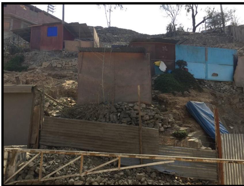
Fotografía N° 19. Viviendas sobre pircas de piedras en zona de Muy alto peligro en el A.H. Nueva Esperanza - V.M.T. - 06/05/2018 (Fuente: Propia)
