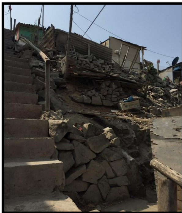
Fotografía N° 23. Viviendas sobre pircas de piedra en ladera de alta pendiente Psje. Perú del P.J Virgen de Lourdes - V.M.T. - 17/02/2018 (Fuente: Propia)
