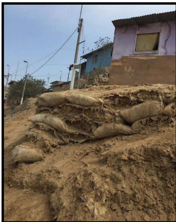
Fotografía N° 24. Viviendas de triplay con base de costales terreros sobre suelos residuales en el C.V. 11- 12 Sur - V.M.T. - 17/02/2018 (Fuente: Propia)
