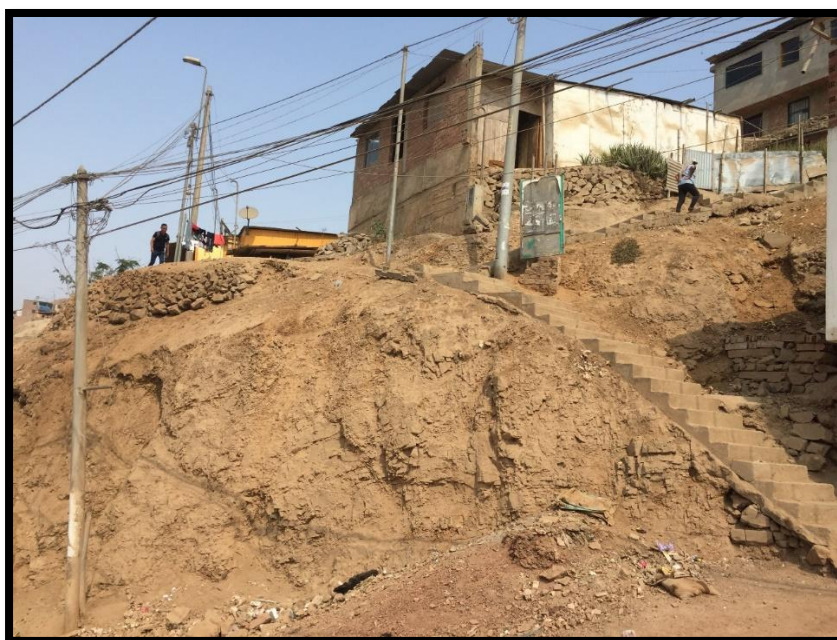
Fotografía N° 20. Vivienda sobre área erosionada en zona de Muy alto peligro en el Sector 38 del P.J Virgen de Lourdes - V.M.T. - 17/02/2018 (Fuente: Propia)
