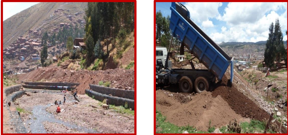
Figura Nro. 2 . Peligro de Inundaciones
