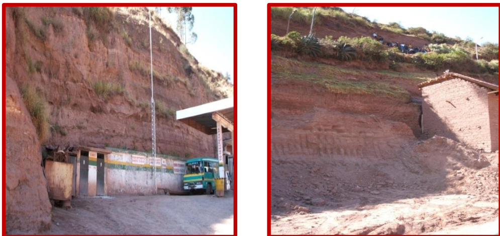
Figura Nro. 1 . Peligro de Derrumbe
