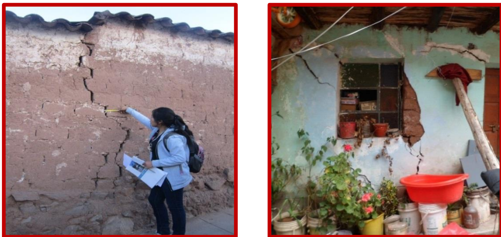
Figura Nro. 14 . Construcciones Inseguras
