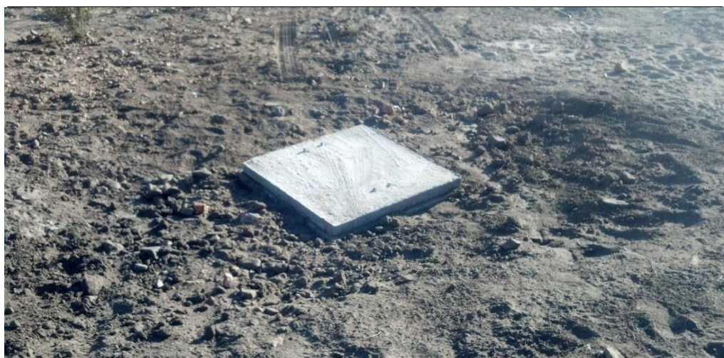
Fotografía N° 1: Trampa de grasa que colecta el ARD del comedor.
