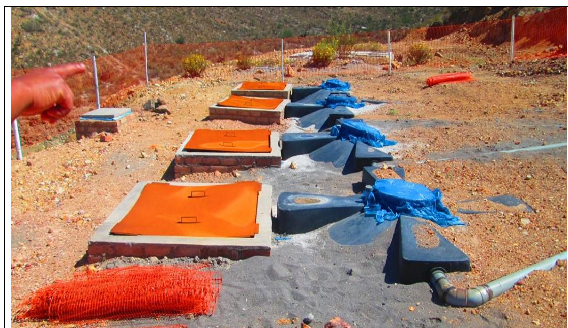
Fotografía N° 2: Cuatro Biodigestores Rotoplast de 7000 L cada uno.
