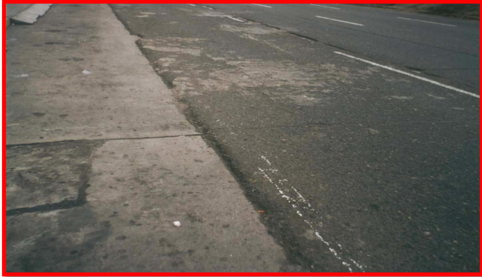
Alta desintegración de la carpeta asfáltica y se pone de manifiesto que la falta de confinamiento lateral permite la destrucción de la carpeta; ubicada en la progresiva 1+839 sobre la vía del Callao a Lima. (Severidad alta). Fuente: Propia.
