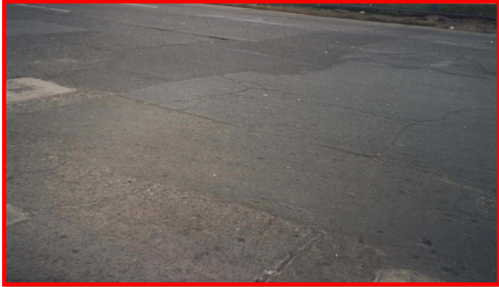
Bache por reparación mal ejecutada, grietas longitudinales y transversales, pérdida del ligante; falla ubicada en la progresiva 1+030 de la vía del Callao a Lima (severidad alta). Fuente: Propia.
