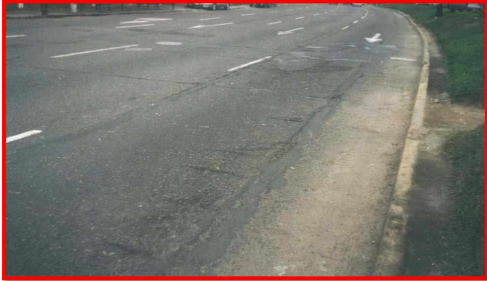
Huecos, baches, grietas de reflexión de juntas y parches por conexión telefónica, también se observa pérdida del ligante y la consecuente desintegración del pavimento ubicada en la progresiva +393 en la vía del Callao a Lima (severidad media-alta). Fuente: Propia.
