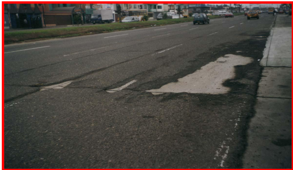
Pérdida del ligante y desintegración total de la carpeta asfáltica, juntas de dilatación de las losas de concreto totalmente abiertas; falla ubicada en la progresiva 1+804 m. sobre la vía del Callao a Lima. (Severidad alta). Fuente: Propia.
