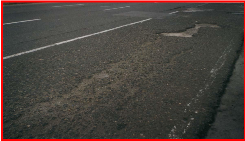
Hueco producido por la desintegración avanzada de la carpeta asfáltica y parche mal ejecutado convertido en bache en la progresiva 2 + 093m. Sobre la vía del Callao a Lima (severidad alta). Fuente: Propia.
