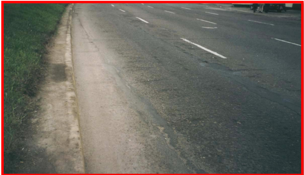
Pérdida del ligante con desintegración, presenta tratamiento anterior insuficiente porque ha seguido progresando la falla ubicada en la progresiva +381 de la vía del Callao a Lima (severidad media). Fuente: Propia.
