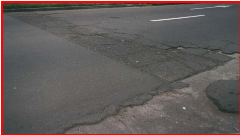
Grietas piel de cocodrilo de alta severidad con desintegración de la carpeta asfáltica en la progresiva 4+180 m. sobre la vía de Lima al Callao. (Severidad alta). Fuente: Propia.
