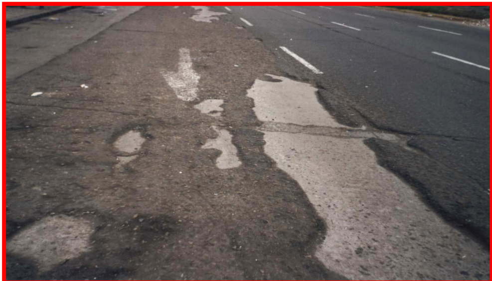
Bache por reparación mal ejecutada, grietas longitudinales y transversales, pérdida del ligante, falla ubicada en la progresiva 1+030 de la vía del Callao a Lima (severidad alta). Fuente: Propia.
