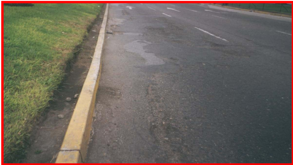
Desintegración progresiva y sellada fallada con huecos de considerables tamaños, posible causa el agua sobre el pavimento proveniente del riego de jardines que existen en el medio de la vía; ubicada en la progresiva 2+300 m. sobre la vía de Lima al Callao. (Severidad alta). Fuente: Propia.
