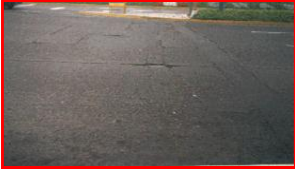
Bache producido por parches mal ejecutado de conexión de luz para semáforo; asociado a esta falla hay grietas transversales y reflexión de juntas; en la progresiva 4+321 m. sobre la vía del Callao a Lima. (Severidad alta). Fuente: Propia.
