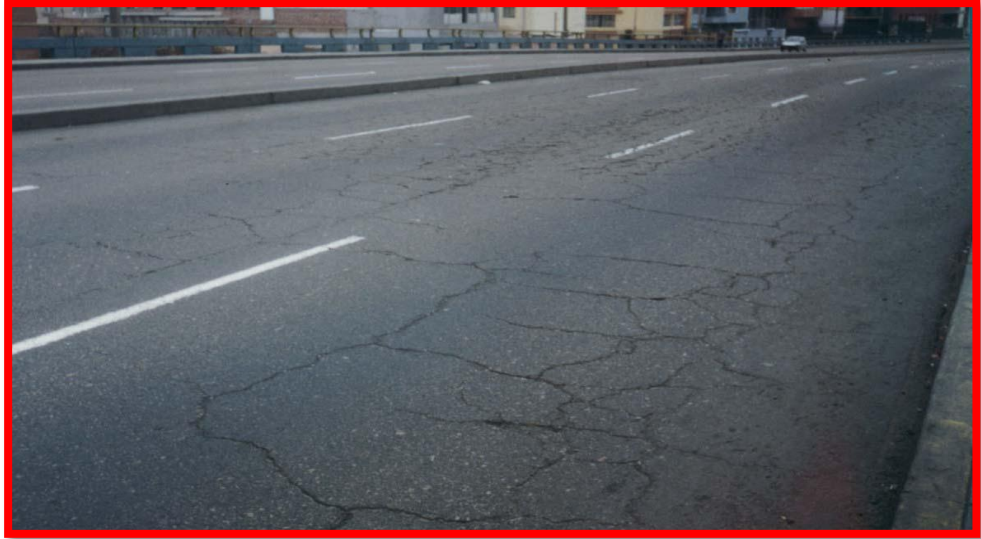
Falla piel de cocodrilo ubicada en la progresiva +093 vías del Callao a Lima. (Severidad alta). Fuente: Propia.
