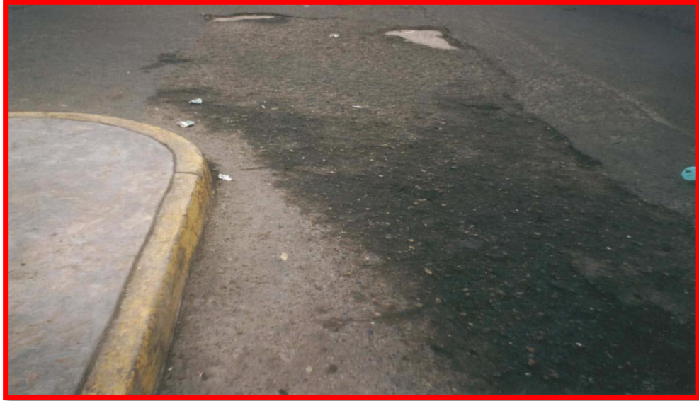
Desintegración avanzada con pérdida total de material bituminoso, se ven dos huecos; ubicados en la progresiva 2+090 m. sobre la vía de Lima al Callao. (Severidad alta). Fuente: Propia.
