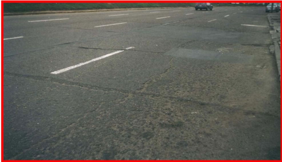
Hundimiento porque cedió la base granular con parche inadecuado; grietas de reflexión de juntas, pérdida del ligante y una progresiva desintegración de la carpeta asfáltica .Falla ubicada en la progresiva +397 en la vía del Callao a Lima. (Severidad alta). Fuente: Propia.
