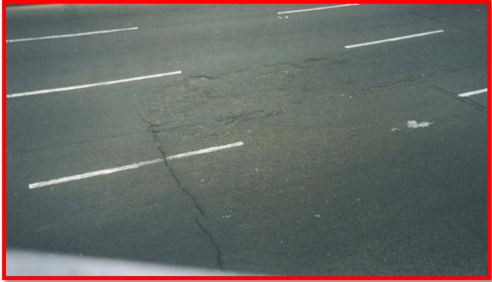
Desintegración de la carpeta asfáltica, asociada con grietas transversales y de reflexión de juntas ubicadas en la progresiva +345 de la vía del Callao a Lima. (Severidad media). Fuente: Propia.
