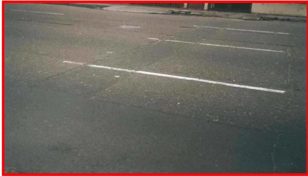
Parque defectuoso y a pesar de ser más reciente que el resto de la carpeta , evidencia también pérdida del ligante que puede deberse a la calidad de cemento asfáltico y no necesariamente a exceso de ligante u otro motivo también se ve reflexión de juntas con severidad alta. Falla ubicada en la progresiva 1+575 en la vía de Lima al Callao. Fuente: Propia.
