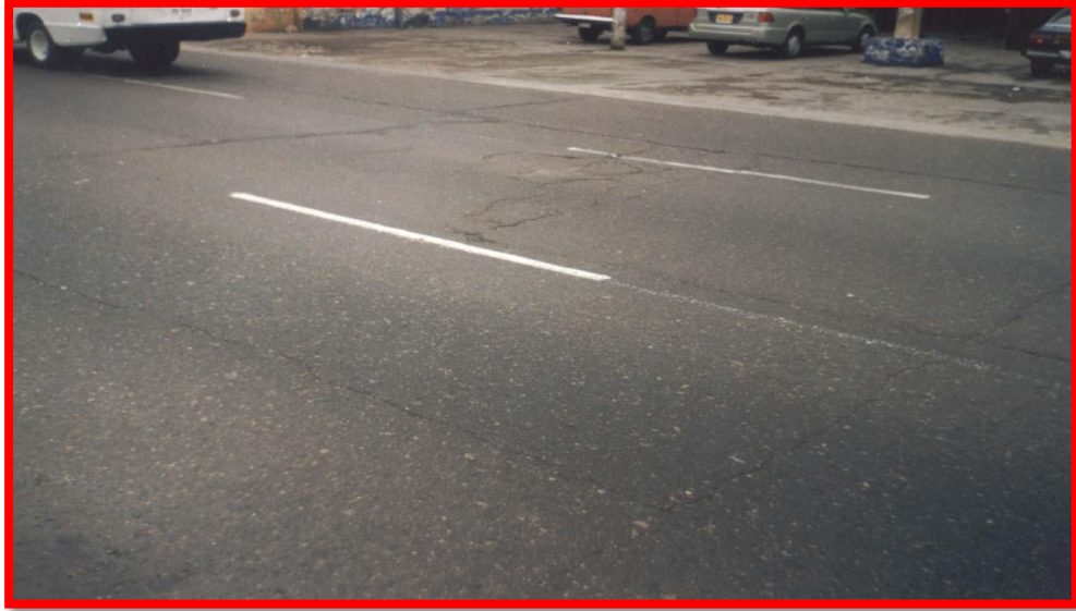
Grietas piel de cocodrilo, con severidad alta por falla en la capa base con asentamiento de la carpeta asfáltica produciendo hundimiento y grietas de reflexión de juntas ubicada en la progresiva +710 de la vía de Lima al Callao. Fuente: Propia.
