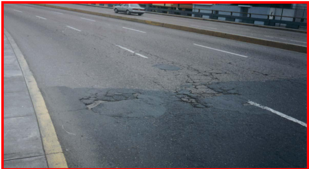
Hundimiento de la carpeta, se observa resane inadecuado y continúa la falla, con grietas longitudinales marcadas; ubicada en la progresiva +276 en la vía del Callao a Lima. (Severidad alta). Fuente: Propia.
