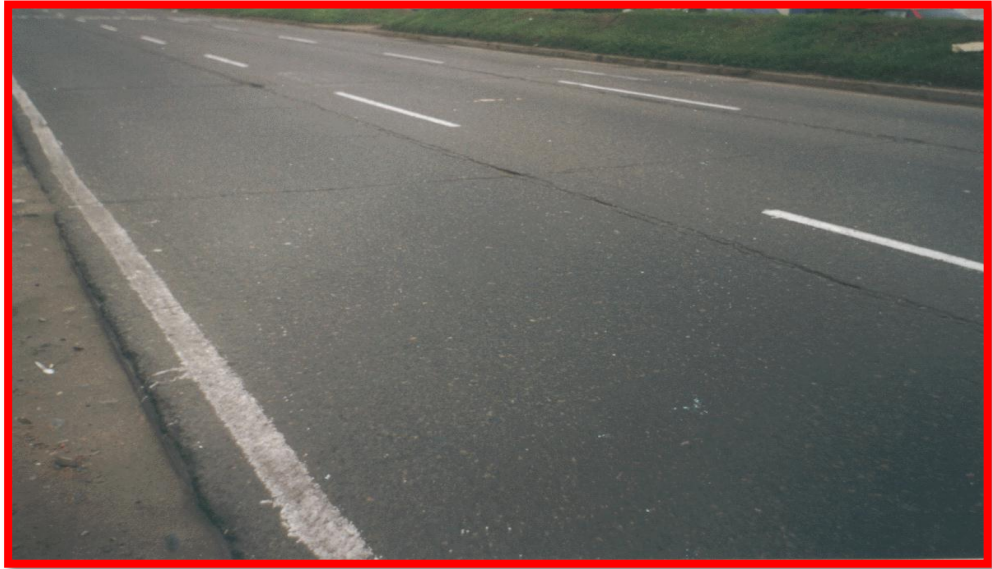
La típica falla de reflexión de juntas a lo largo de toda la Av. Marina; selladas anteriormente pero de forma inadecuada y la terminación del borde de la calzada sin confinamiento que conllevará con el tiempo al desintegración y deterioro de los bordes, falla ubicada en la progresiva 1+245 m. de la vía del Callao a Lima . (Severidad alta). Fuente: Propia.
