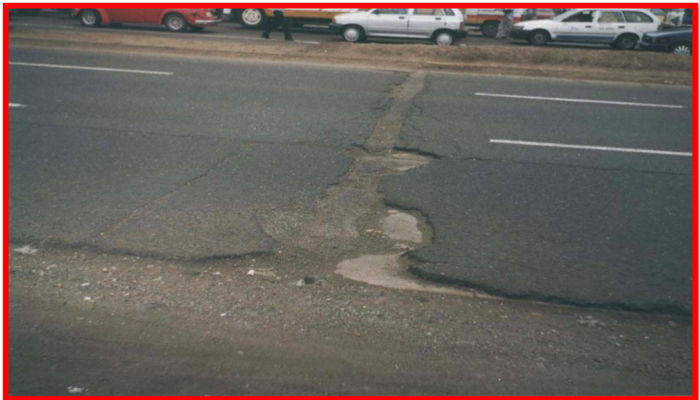
Pérdida total del carpeta asfáltica y ya empieza a comprometer las losas de concreto de cemento Pórtland. Falla ubicada en la progresiva 1+465 de la vía del Callao a Lima. (Severidad alta). Fuente: Propia.
