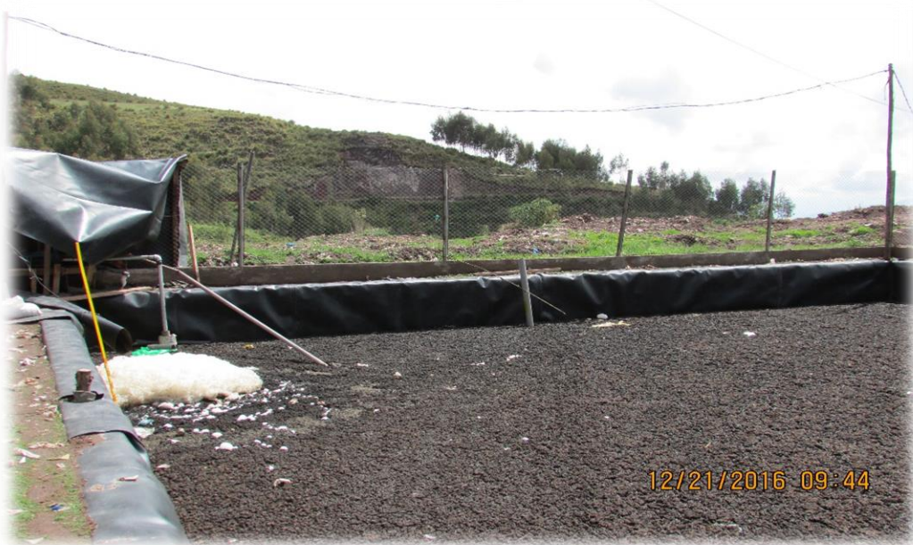
Fotografía N° 24: Pozo de almacenamiento de lixiviados para su evaporación.
