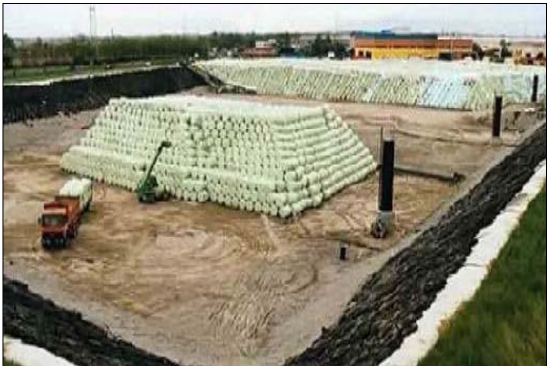
Figura N° 5: Relleno sanitario de alta densidad en balas
