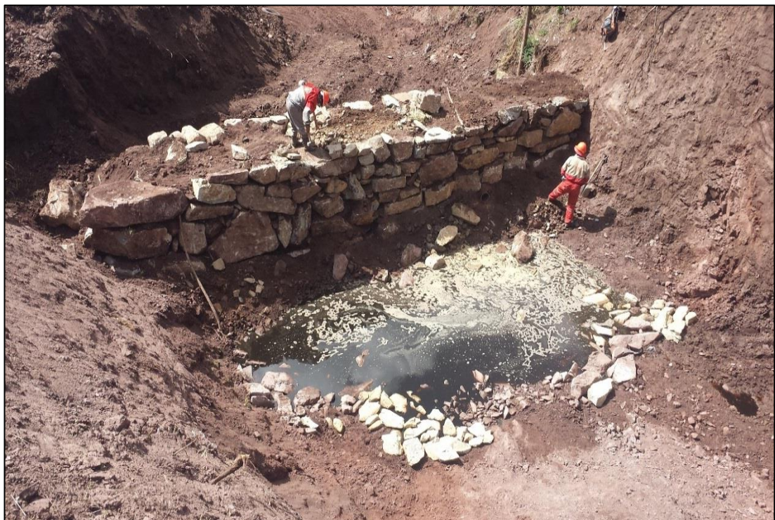
Fotografía N° 6: Lixiviados acumulada quebrada abajo del botadero de Haqira
