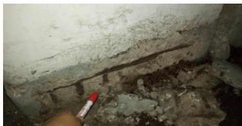
Fotografía N°6. Presencia de corrosión expuesta en parte inferior de columna Sótano – Casa Matriz.
