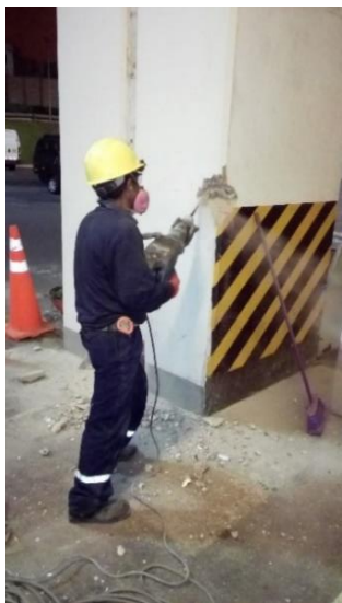
Fotografía N°19. Picado puntual en parte central de columna del Sótano – Casa Matriz.
