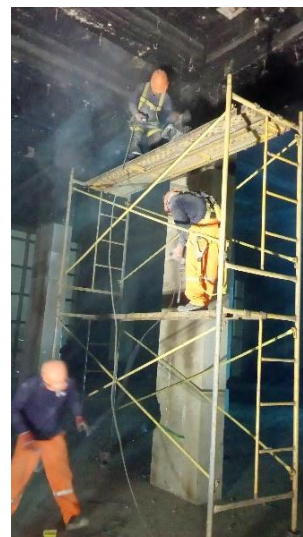
Fotografía N°22. Picado puntual en parte superior de columna del 4° Nivel – Torre Medica.
