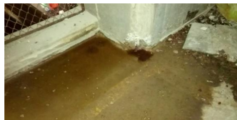
Fotografía N°7. Presencia de residuos orgánicos en contacto permanente con columnas 3° Nivel – Casa Matriz.
