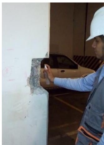
Fotografía N°35. Aplicación de la fenolftaleína sobre una fractura fresca columna de Sótano – Casa Matriz.
