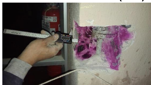
Fotografía N°41. Prueba de carbonatación en columna de 2° nivel - Gimnasio.
