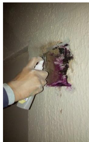
Fotografía N°36. Aplicación del indicador de pH sobre una fractura fresca en columna de 1° Piso – Gimnasio.
