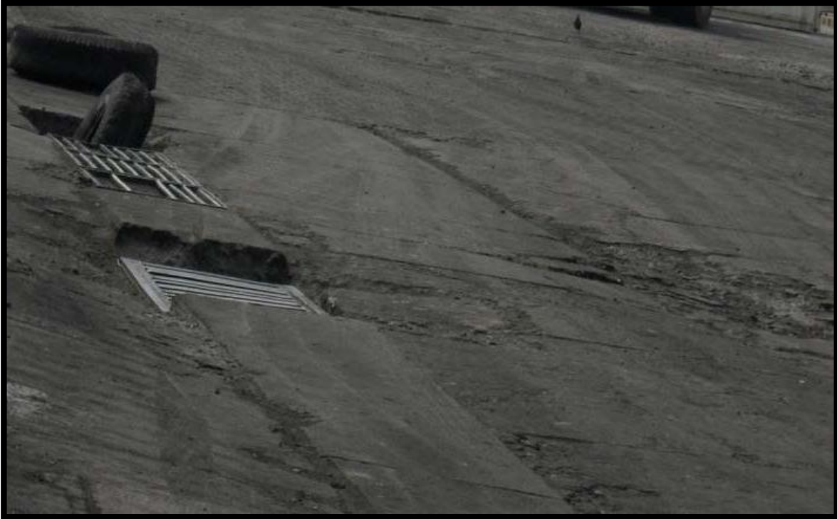
Grieta en bloque. Fuente: Propia.
