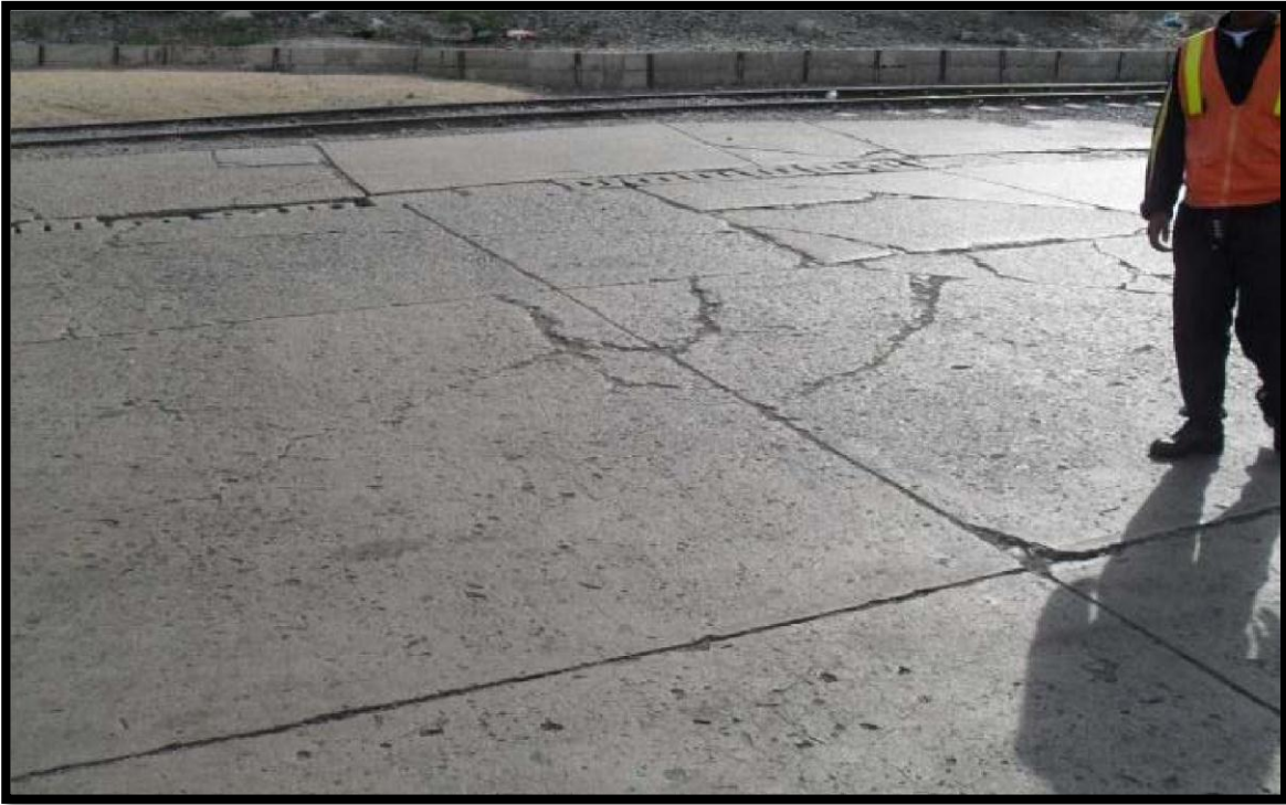
Grietas de Esquina. Fuente: Propia.
