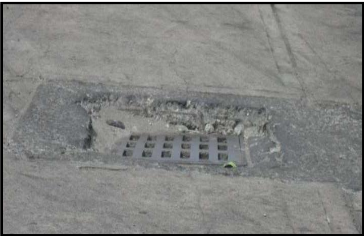
Fracturación en bloque. Fuente: Propia.
