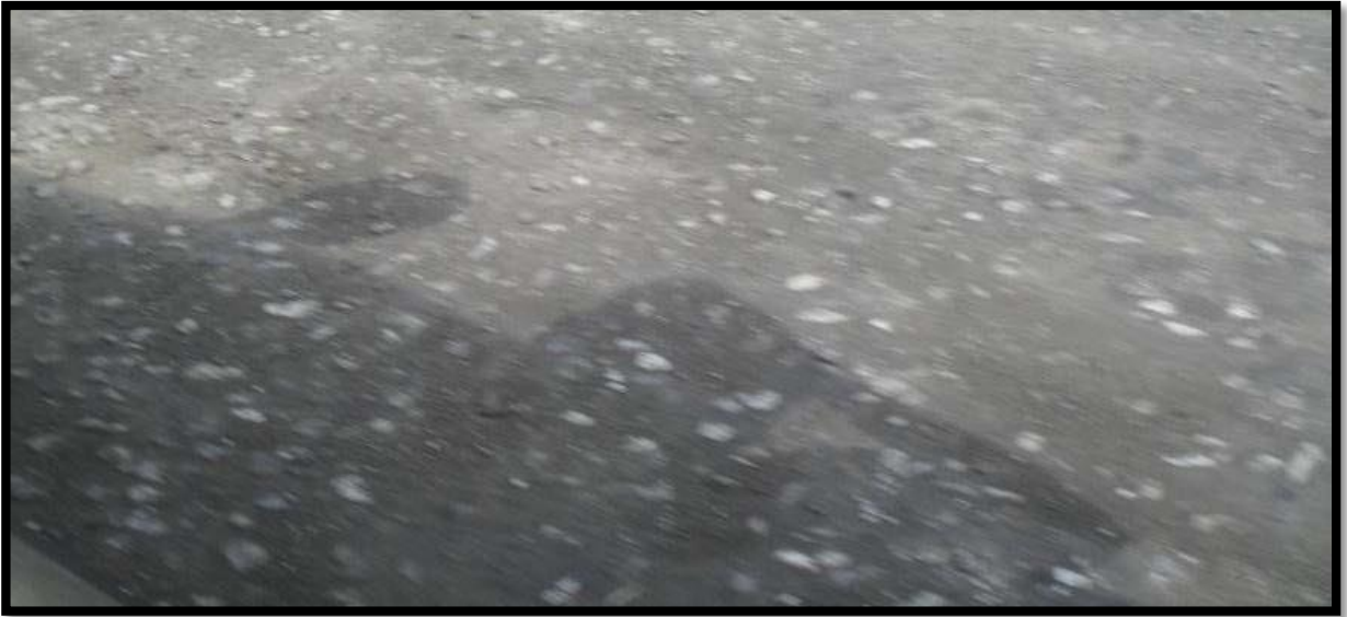
Desintegración de losa. Fuente: Propia.
