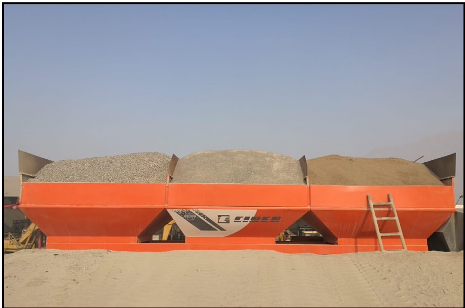
Se aprecia los 3 agregados en la tolva de la planta de asfalto. Fuente: Propia.
