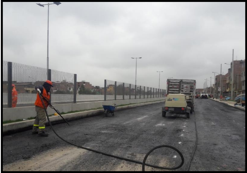
Limpieza con compresora de la base imprimada, para luego proceder a colocar la capeta asfáltica. Fuente: Propia.
