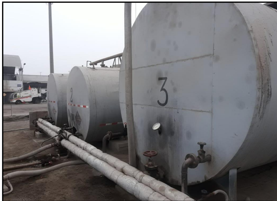
Tanques en las que se almacena el PEN, están conectados a la planta de asfalto. Fuente: Propia.
