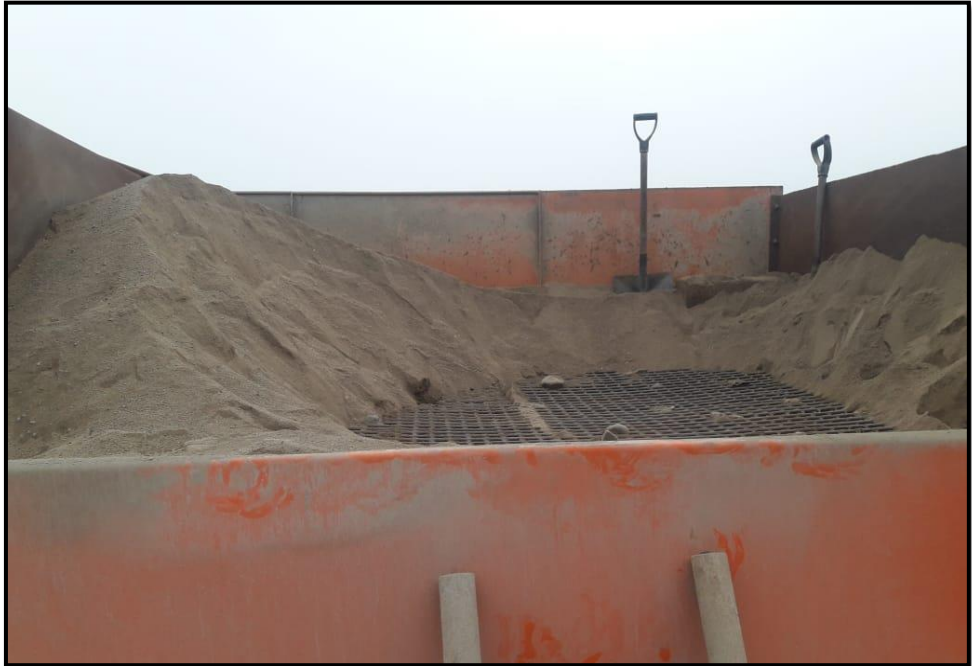
Se aprecia la Arena Natural en la tolva de la planta de asfalto. Fuente: Propia.
