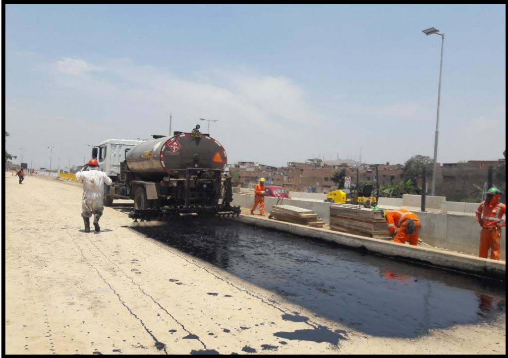
Imprimación asfáltica (MC 30), se está usando la barra para la imprimación. Fuente: Propia.
