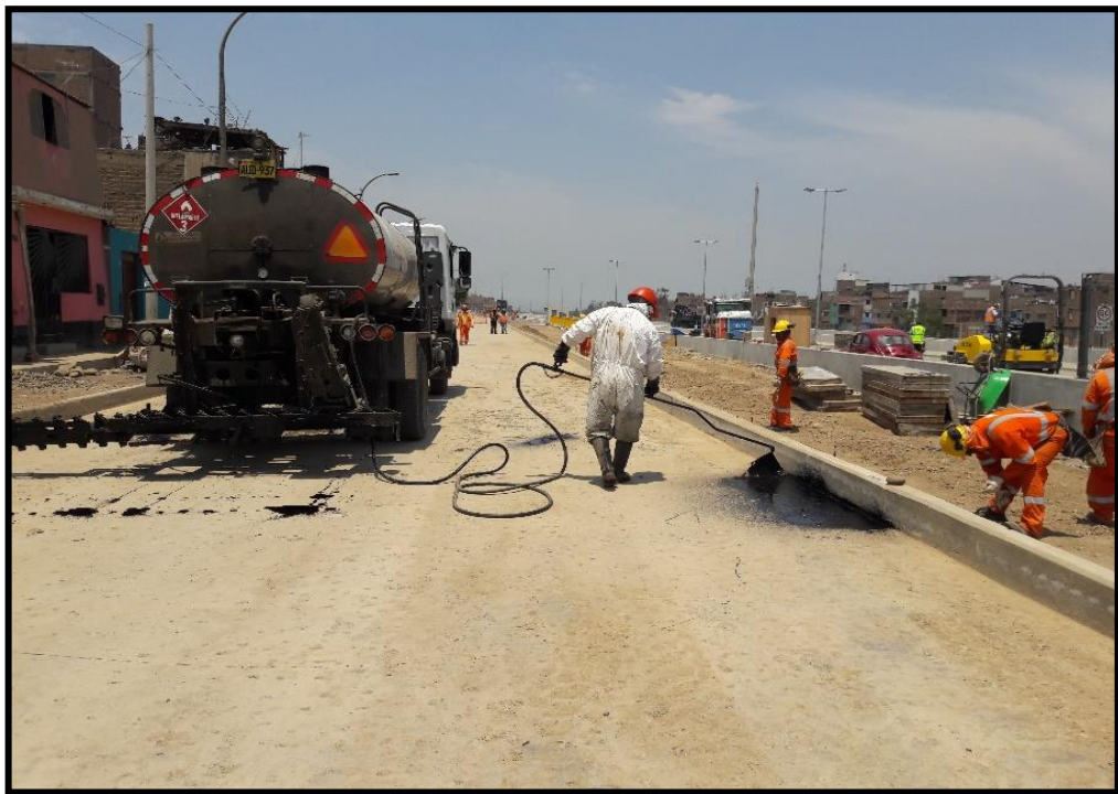
Imprimación asfáltica (MC 30) de los bordes usando el bastón del tanque imprimador. Fuente: Propia.
