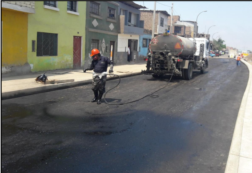
Aplicación de la emulsión asfáltica Emultec, ligante usado entre la primera y segunda capa. Fuente: Propia.
