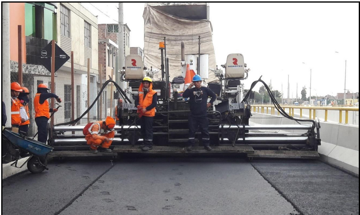
Colocación de carpeta asfáltica con Pavimetadora, se aprecia a personal de control de calidad tomando lectura de la temperatura de la mezcla asfáltica. Fuente: Propia.
