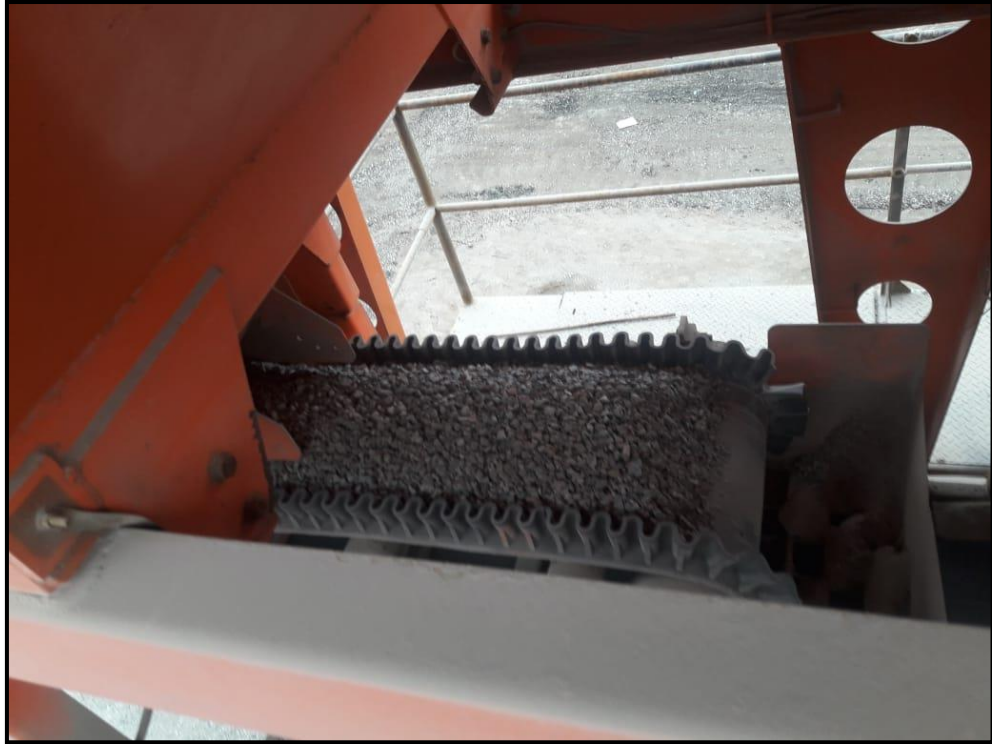
Faja de la planta de asfalto transportando agregado grueso, la velocidad de la faja son monitoreadas para una correcta dosificación de agregados. Fuente: Propia.
