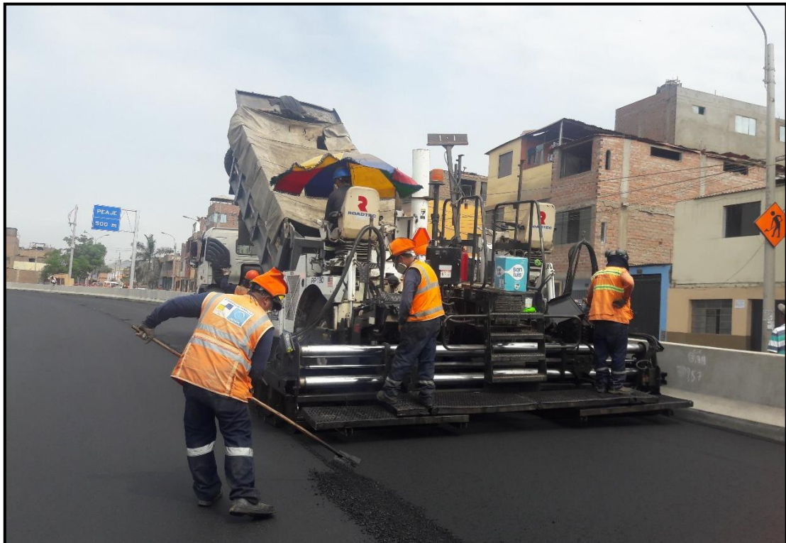
Colocación de carpeta asfáltica con Pavimetadora, se aprecia a personal rastrillero verificando el correcto empalme con la con el carril antes colocado.
