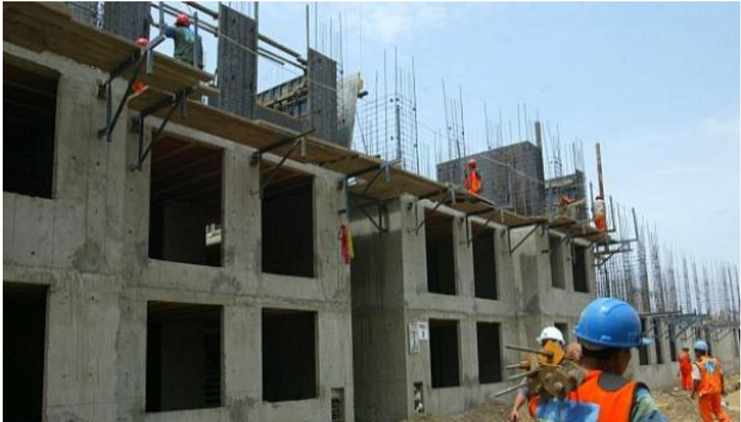
Imagen No 9: Proceso Constructivo de Estructuras Bloque D, del Conjunto Residencial Los Huertos. Fuente: De Documentación de Oficina Técnica de Obra.
