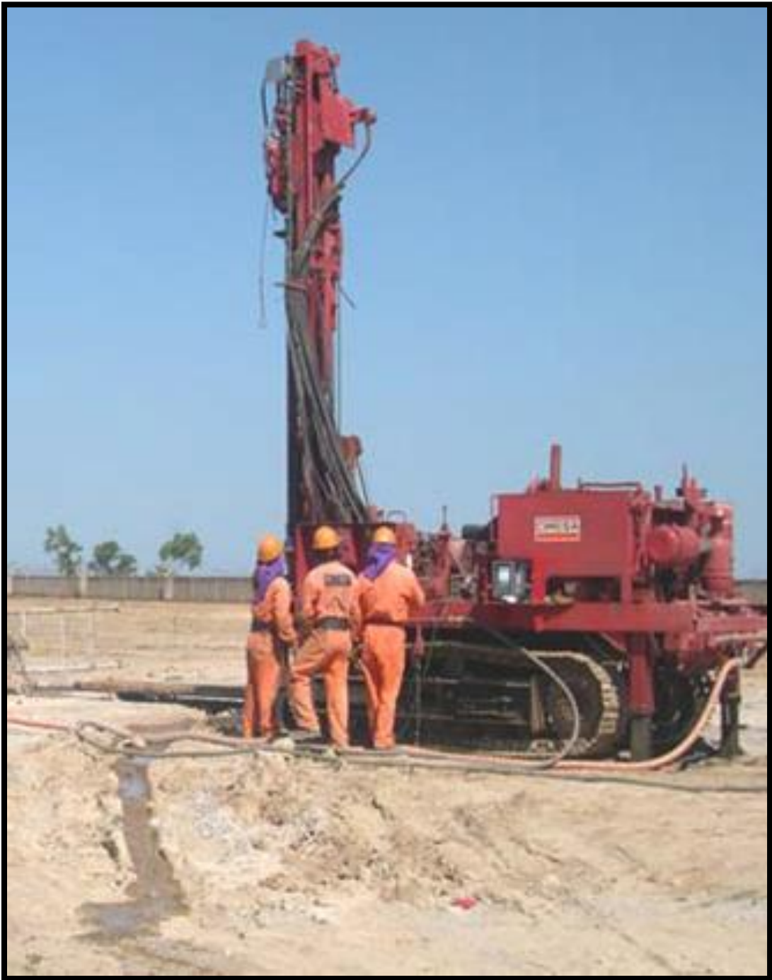
Equipo de inyección.
