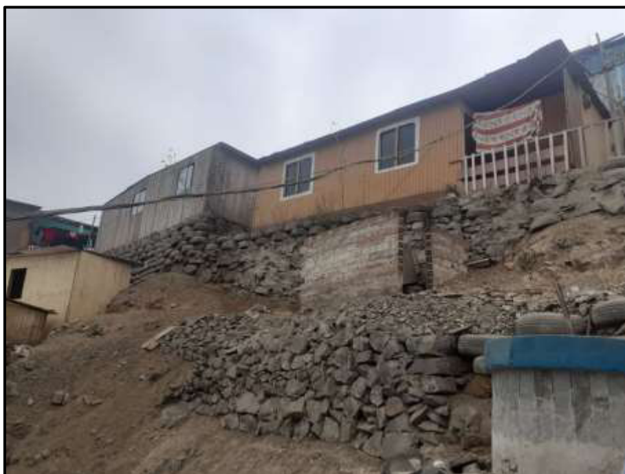
Presencia de pircas inestables de mas de 1.50 metros de altura, se observa tambien laderas inestables.
