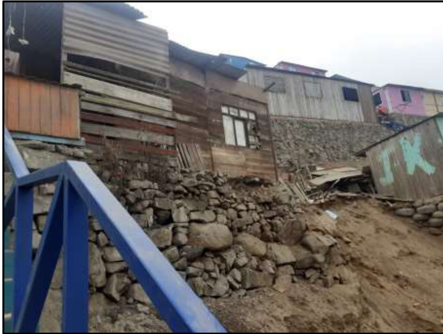
Se observa viviendas precarias asentadas en pircas inestables y sobre material suelto, que se encuentran vulnerables ante un movimiento sísmico y caída de rocas.
