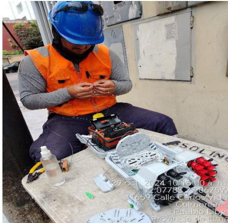
Acondicionamiento de caja naps
