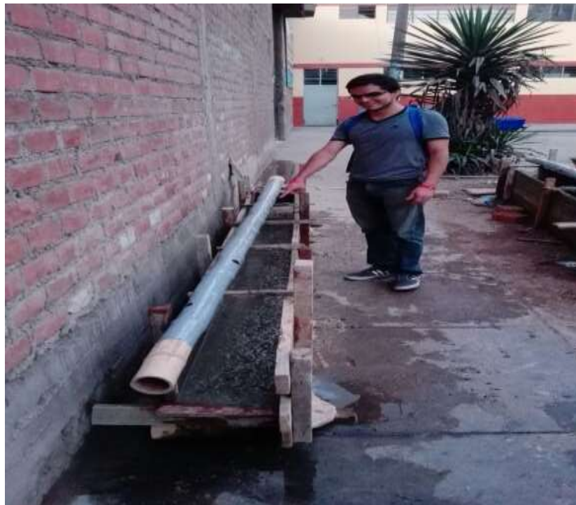
Fig.30 –Encofrado de Viga con refuerzo de bambú ya colocado el adhesivo Fuente: Propia
