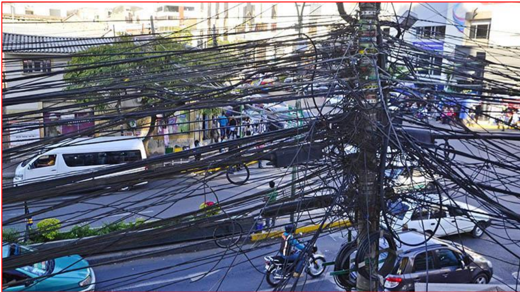
Foto 4 Cableado aéreo excesivo en la ciudad
