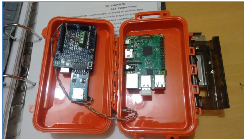
Fotografía 1; Equipo visto interiormente.
