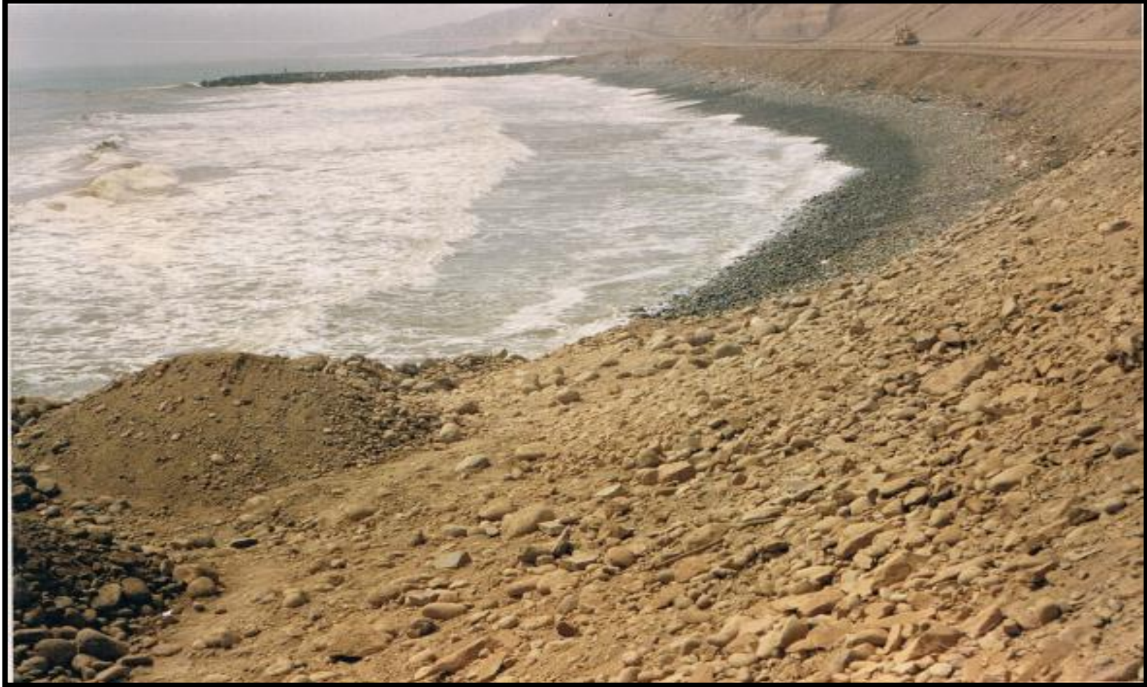
Foto 3: Tramo E1-E2, parte en curva y con erosiones semicirculares. Fuente: Propia.
