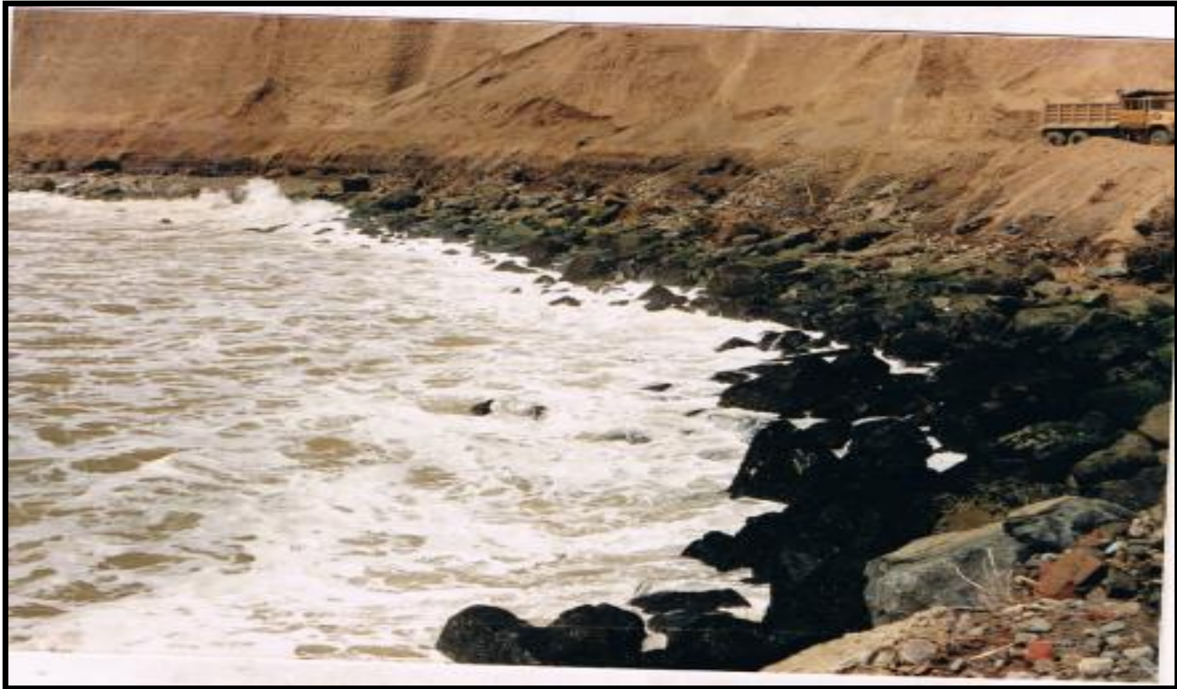
Foto 12: Olas reventando al pie del relleno erosionado, espigón E3. Fuente: Propia.
