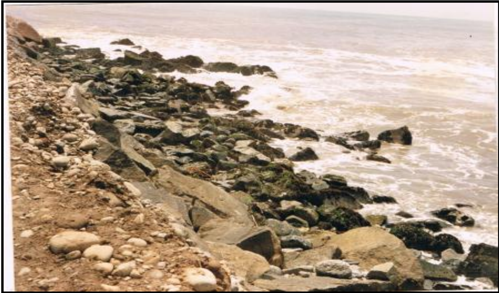
Foto 8: Protección con enrocado mayor y rocas menores desparramadas. Fuente: Propia.
